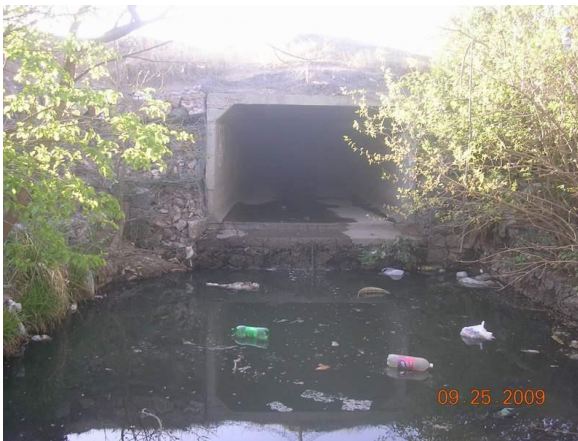
Foto 5: Erosión en la descarga
