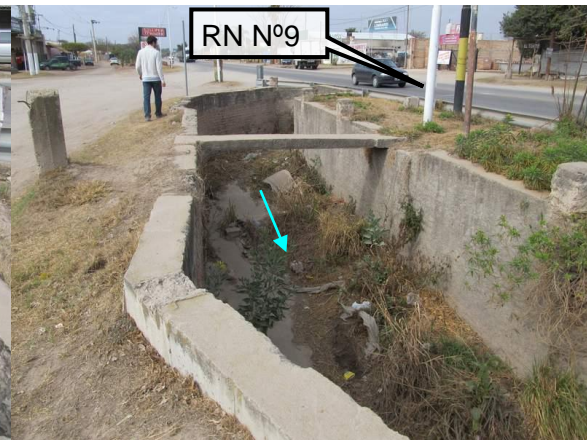
Foto 14: Cámara de descarga de alcantarillas.
