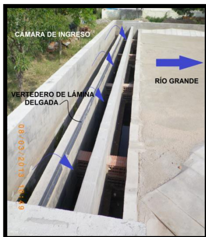
Figura 14: Cámara de ingreso Río Grande
