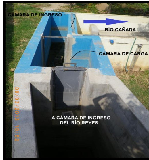
Figura 12: Cámara de carga del Río Reyes
