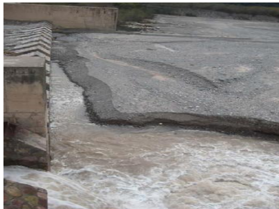
Figura 8: Erosión localizada al pie del canal moderador
