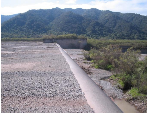
Figura 4: Tarquinamiento del dique fijo
