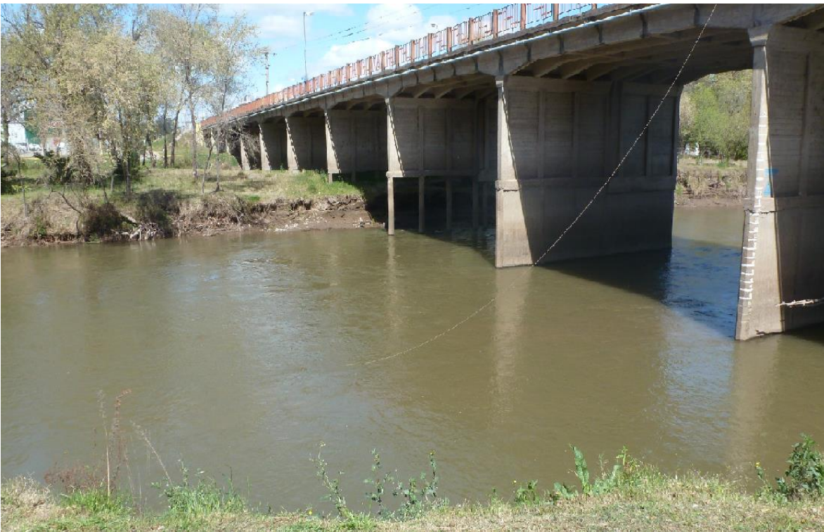
FIGURA 2. 3. SECCIÓN DE AFORO EN EL RÍO TERCERO, AGUAS ABAJO DEL PUENTE JUAN BAUTISTA ALBERDI DE LA CIUDAD DE VILLA MARÍA.
