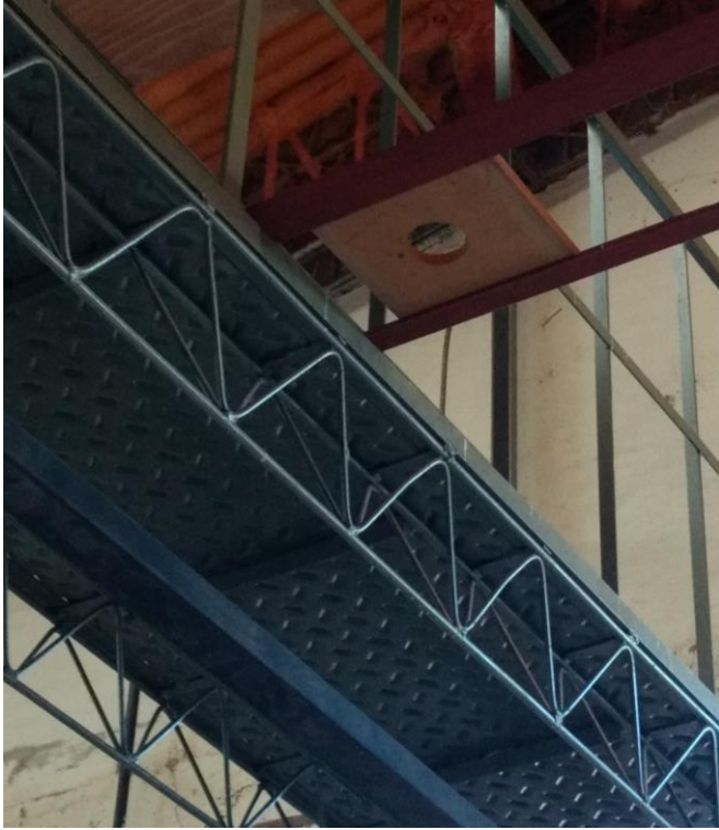
Figura 4. 34: Soporte para cámara sobre pasarela colgante.
