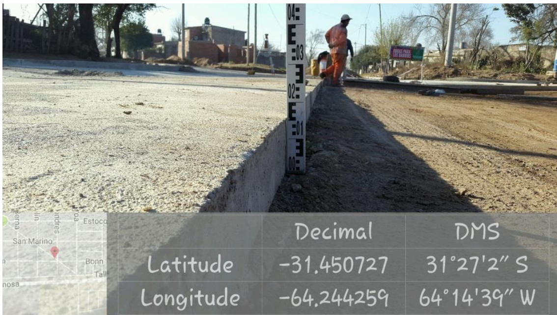
Figura 44. Espesor del hormigón de la bocacalle de Copenhagen, Bonn y De Isasi.
