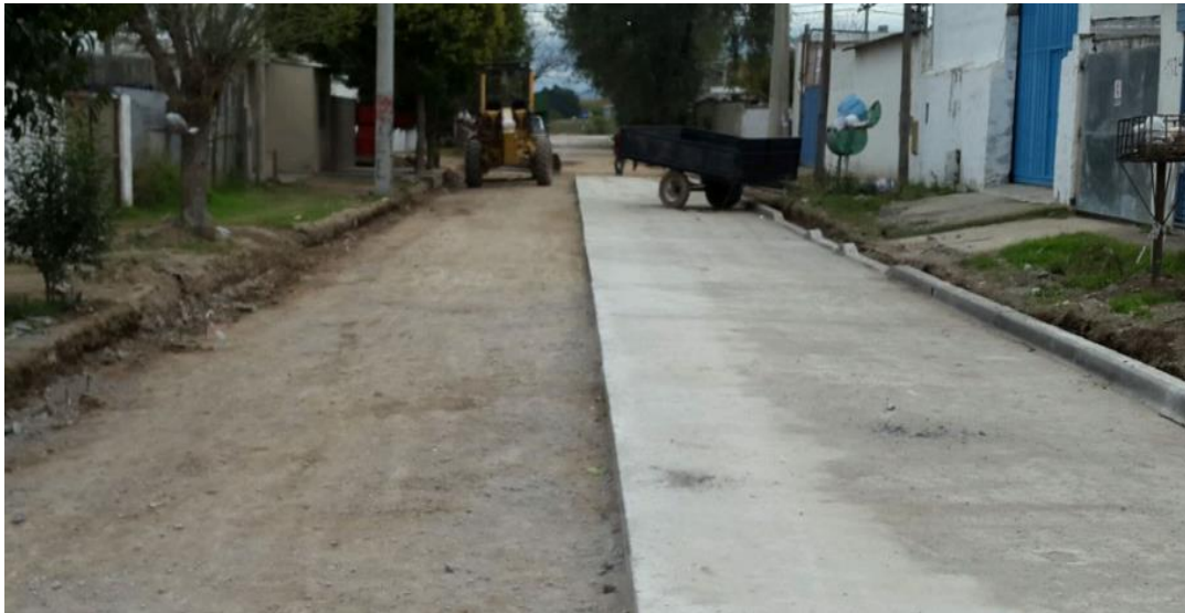
Figura 38. Hormigón de media calzada de la calle Los Pinos entre Avdor. Locatelli y Casavega.
