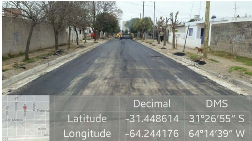
Imagen 2. Carpeta asfáltica entre Estocolmo y San Marino.
