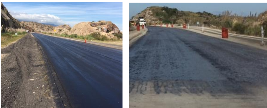
Figura 6.32: Riego de liga en calzada- a) Vista del riego, b) Finalización de la cancha aprobada para riego de liga
