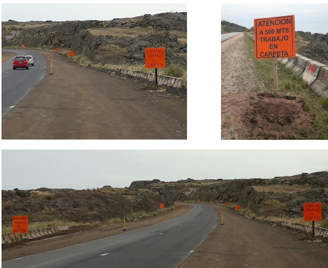
Figura 6.43: Señalización Transitoria- a) y b) Carteles de aviso de trabajo en Carpeta, c) Señalización de obra con Demarcación del Pavimento Provisoria
