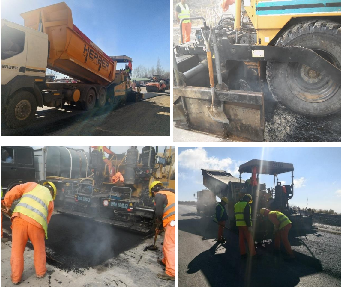
Figura 6.34: Operación de Extendido de la Mezcla- a) Descarga de la mezcla en Extendedora, b) Tornillos Helicoidales de la Extendedora, c) Rastrillero realizando Juntas Transversales, d) Juntas Longitudinales
