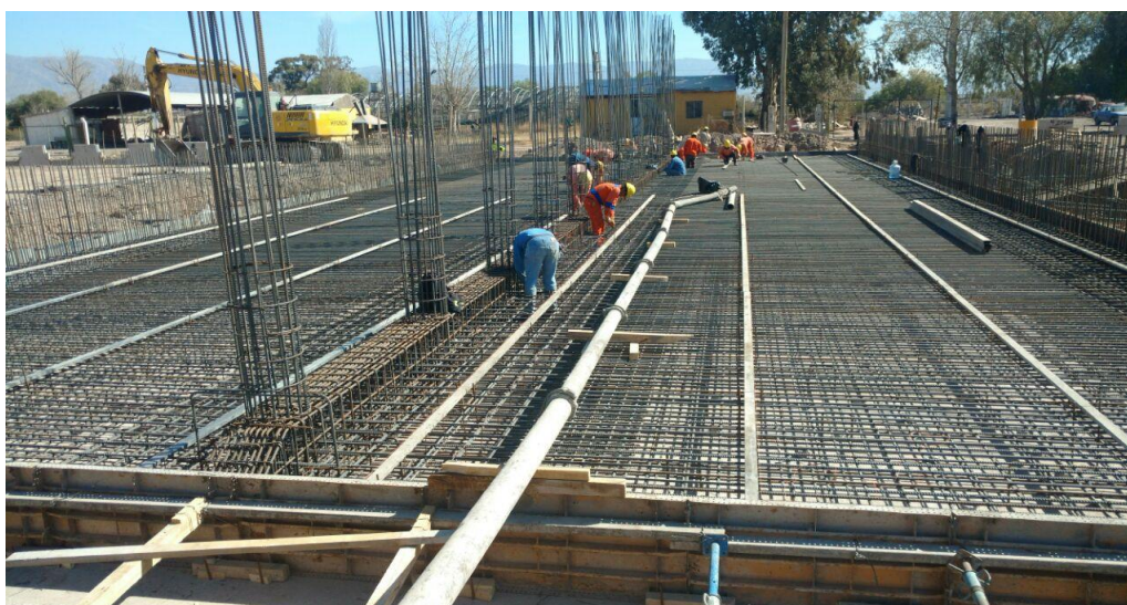
Fig. 3.1 Losa con gran densidad de armadura en la cual se usará H21 Bombeable
