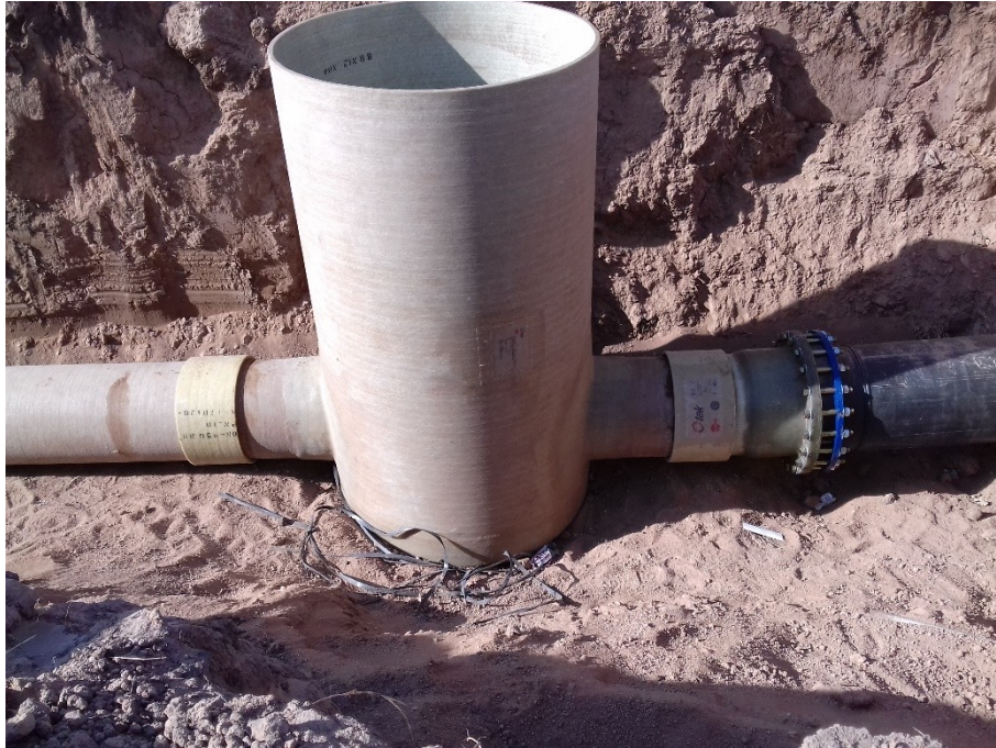
Imagen N° 7.55: Boca de Registro. Transición de materiales PRFV y PEAD mediante pieza especial bridada
