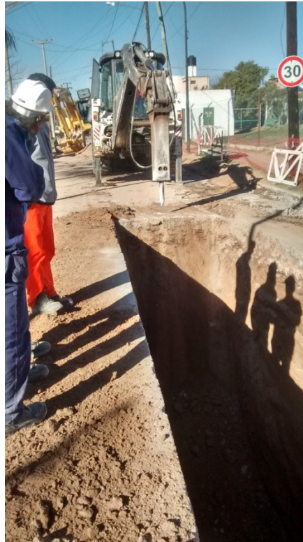
Imagen N° 4.34: Rotura de pavimento
