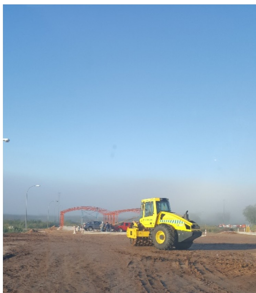
Imagen N° 4.38: Área para sedimentadores primarios, se completo 1,5 m terraplenes de la primera parte.
