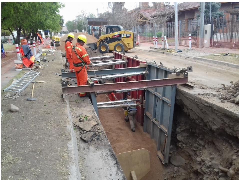
Imagen Nº 4.5: Taras de relleno y compactación de arena. Calle Pascal entre Rutherford y Garzón.
