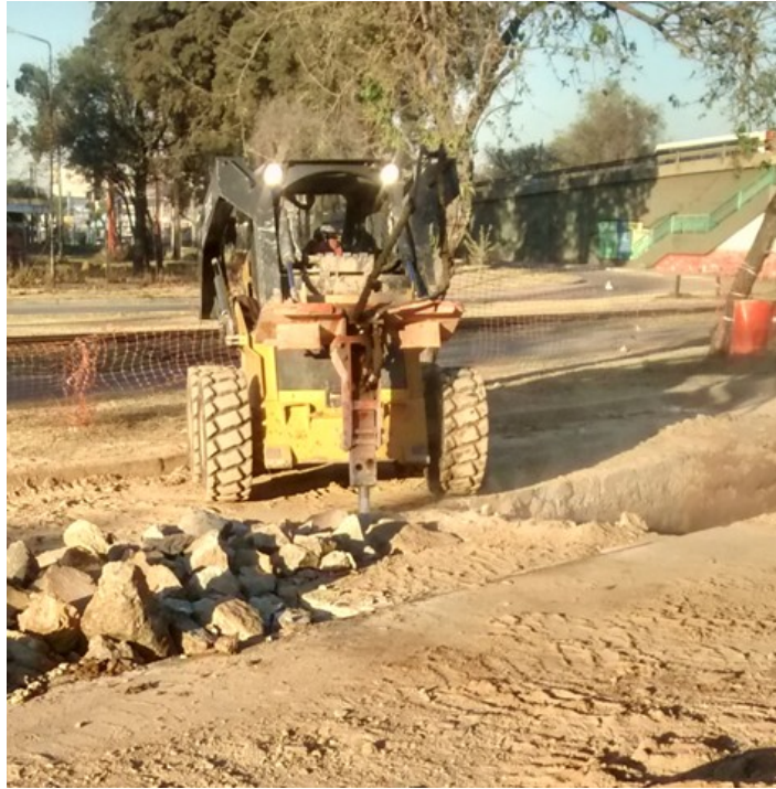
Imagen N° 7.3: Rotura del pavimento
