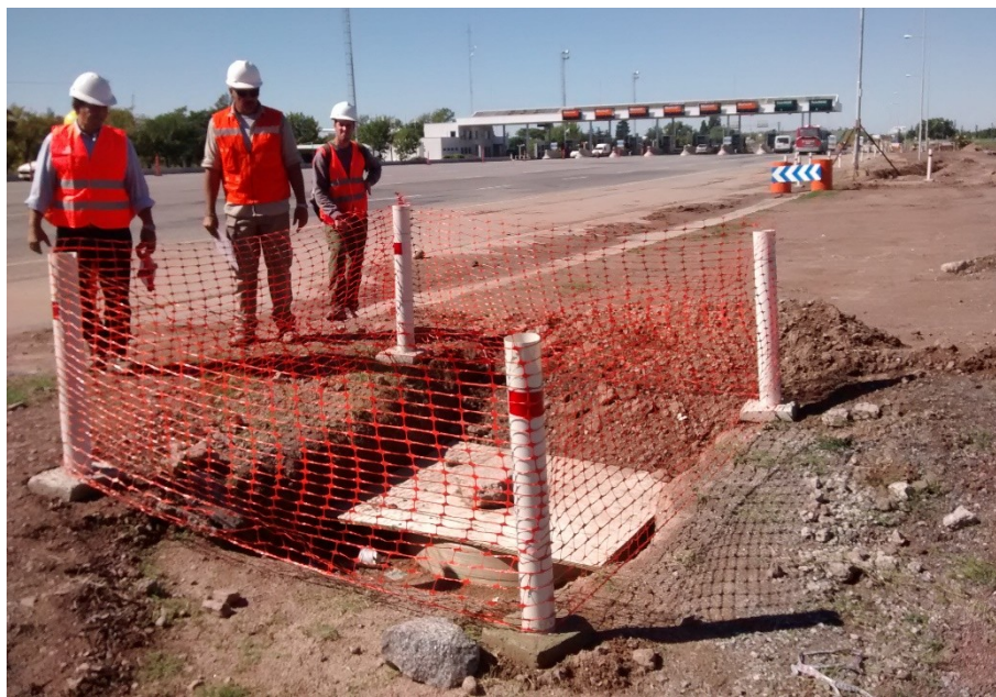
Imagen N° 4.17: Boca de Registro N°1. Inicio de traza Colector Norte. Progresiva +0.00m.
