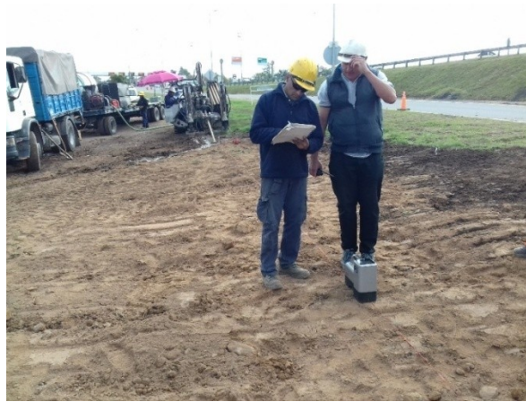
Imagen Nº 7.50: Control de la dirección del caño con el sensor.
