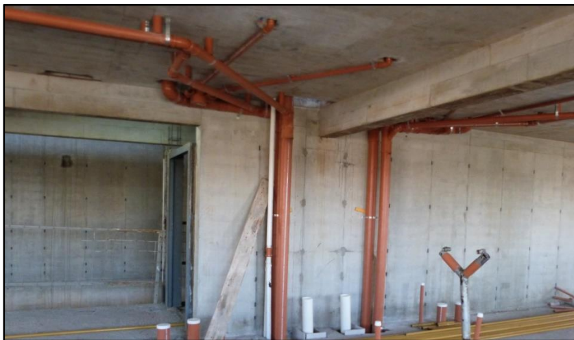
Figura 4.28: Instalaciones sanitarias en departamentos.
