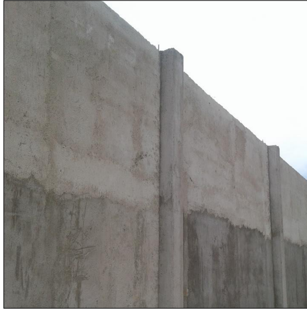
Figura 4.5: Revoque grueso sobre pared medianera.
