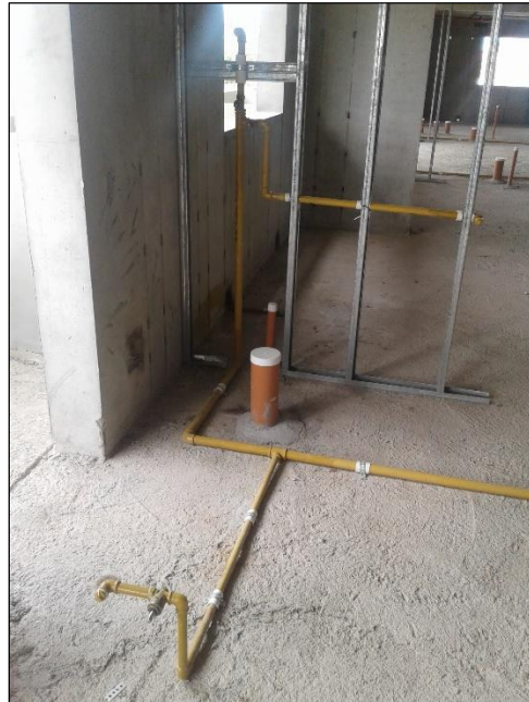
Figura 4.30: Instalaciones de gas en cocina.
