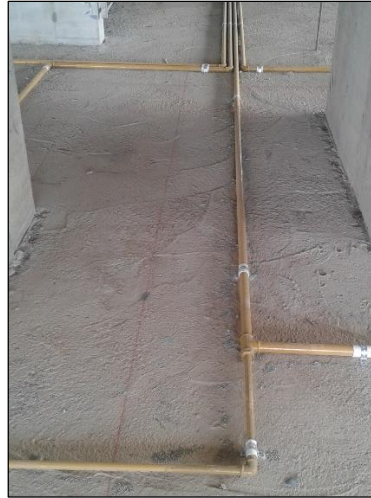
Figura 4.29: Instalaciones de gas.
