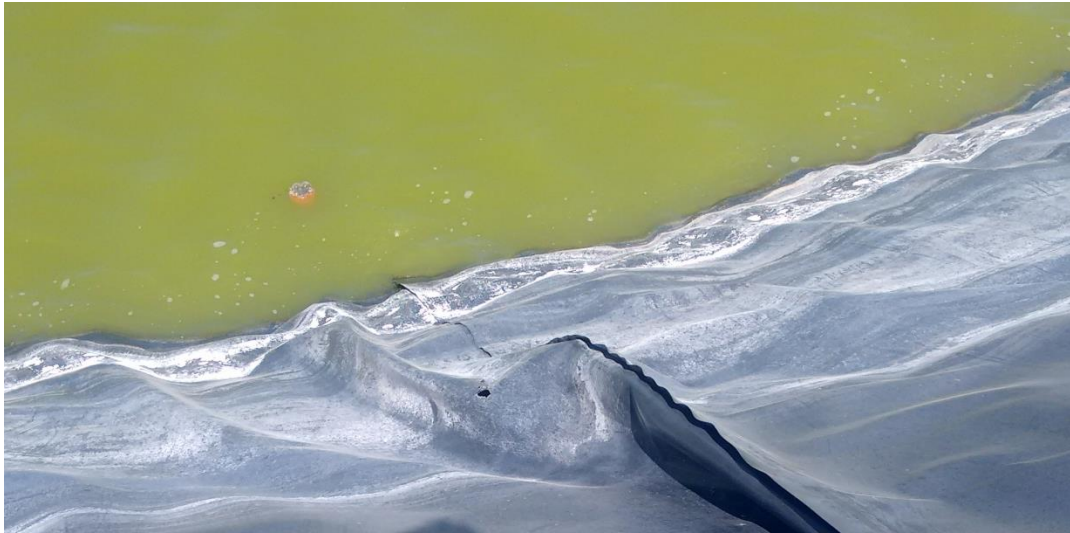
Figura 7: Laguna facultativa con desperfectos (membrana rasgada).
