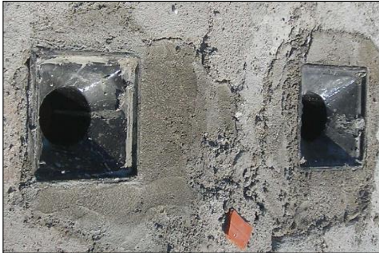
Embudos de desagües pluviales
