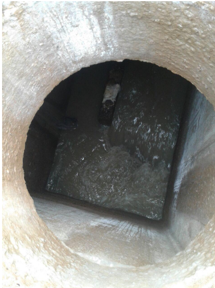
Figura N° 3.3.1.2. Sifón en funcionamiento en calle Caraffa.
