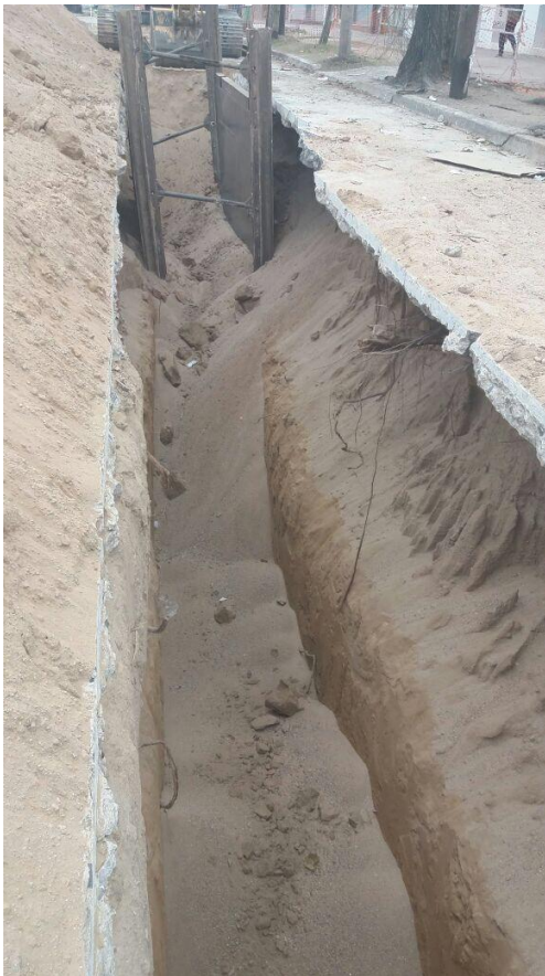
Figura N°4.1. Desmoronamiento en calle Duarte Quirós.
