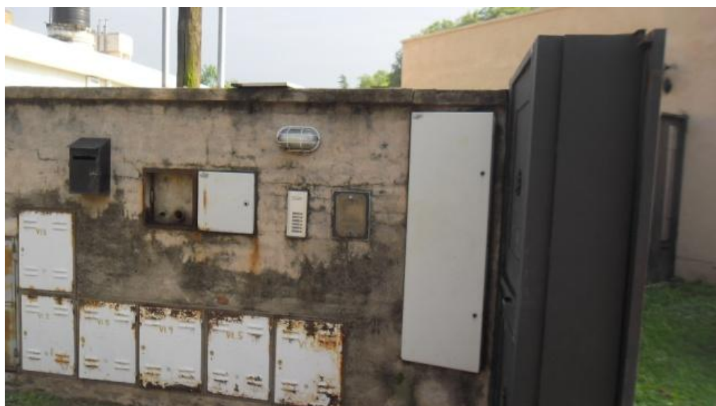
Figura 5.14: Medidores de gas que impiden el paso hacia la parcela 56.
