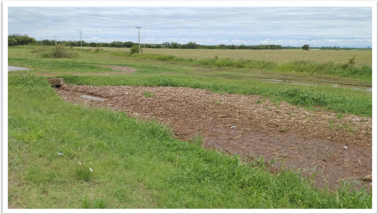
Fotografía 29. Cuneta sobre ruta C-45 con una gran acumulación de rastrojo obstruyendo una alcantarilla.
