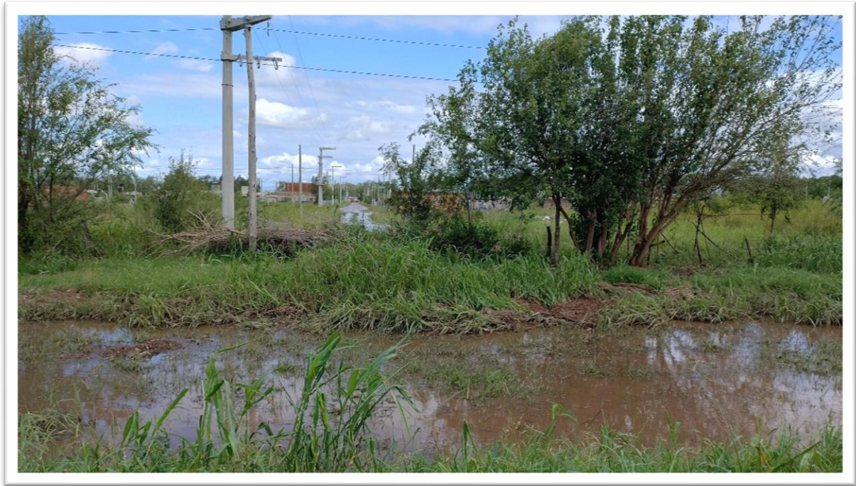
Fotografía 7. Salida de alcantarilla sobre RP N° 5, con descarga hacia el barrio Mitimay de Villa del Prado (se ve la calle inundada).
