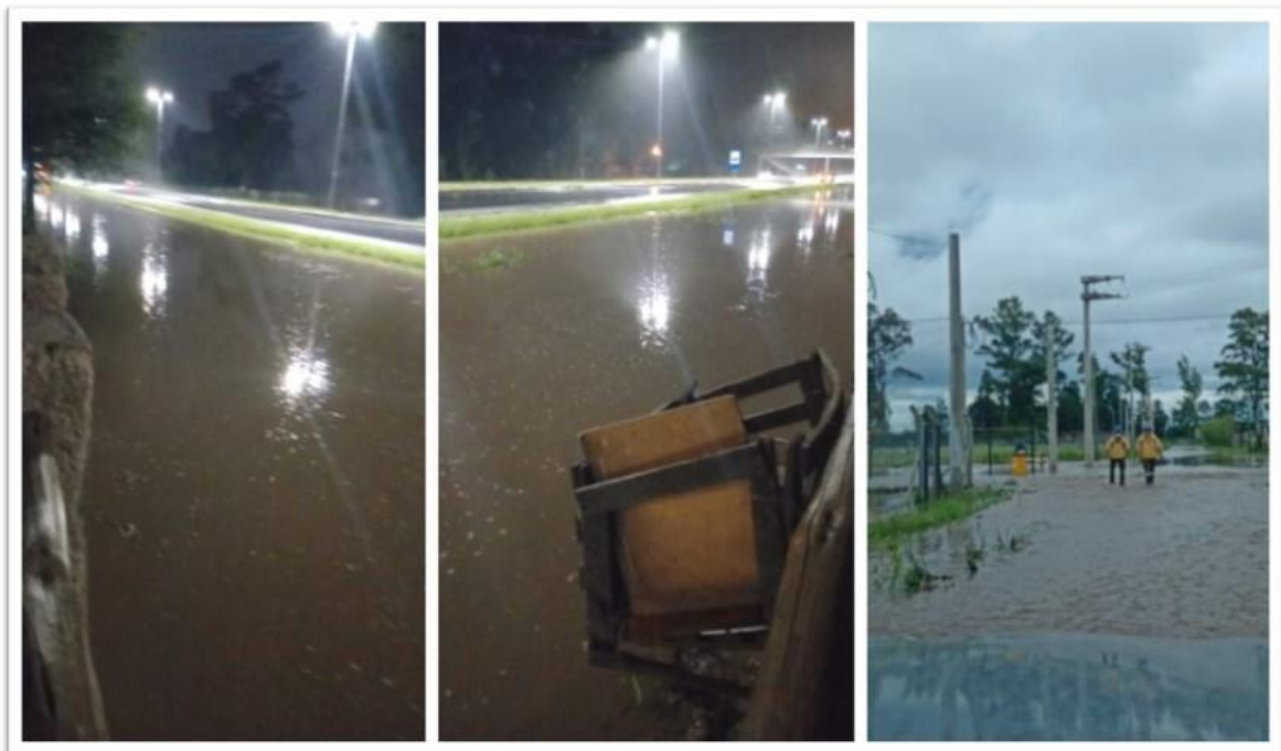
Fotografía 3. Cunetas inundadas y desbordadas en la Ruta Provincial N°5 (Fuente: Mi Valle Medios).
