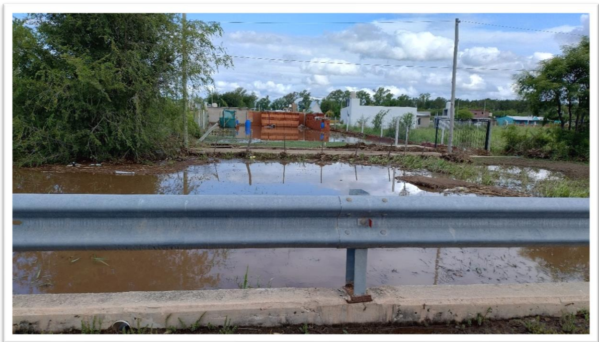
Fotografía 24. Alcantarilla sobre RP N° 5, con descarga directamente hacia lotes y edificaciones en barrio Mitimay.
