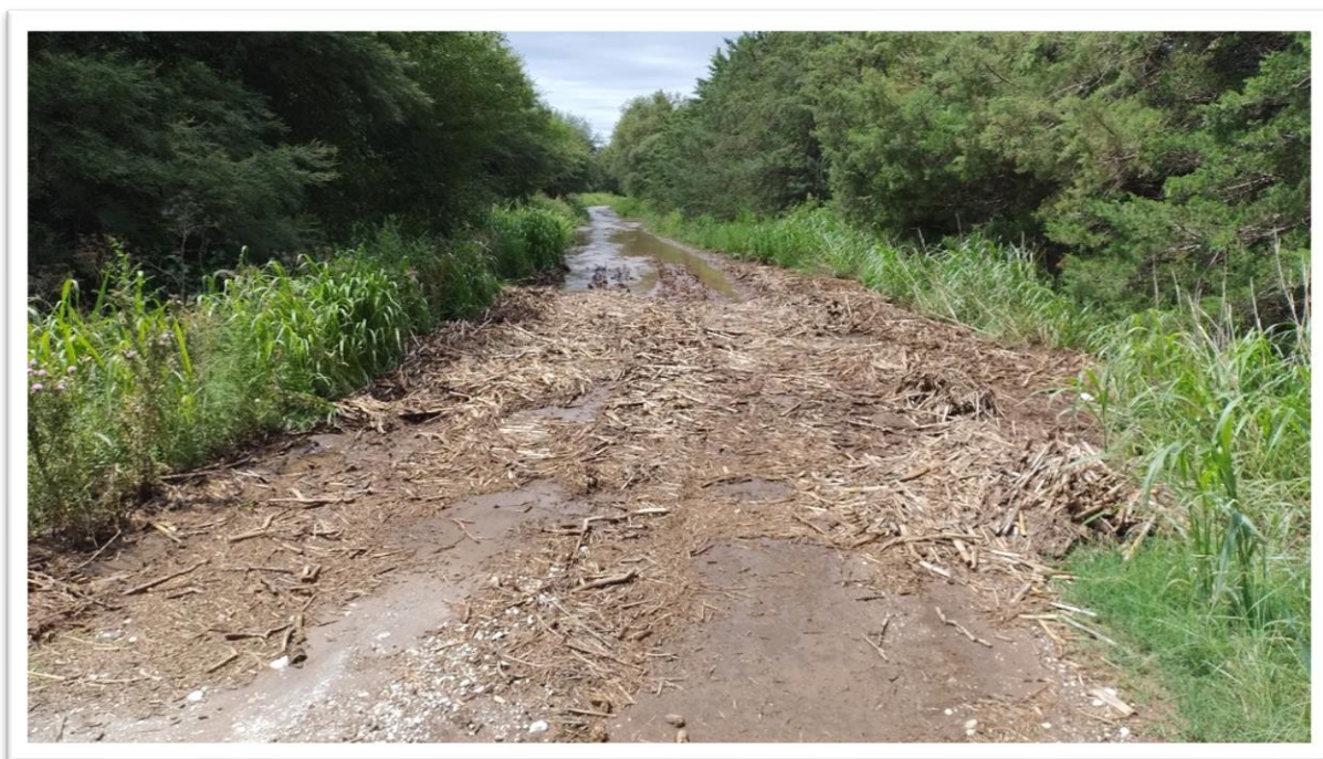
Fotografía 6. Camino rural intransitable llegando a la ruta C-45, funcionando como canal (todavía corría agua por el centro). Se observa rastrojo de maíz sobre el camino.
