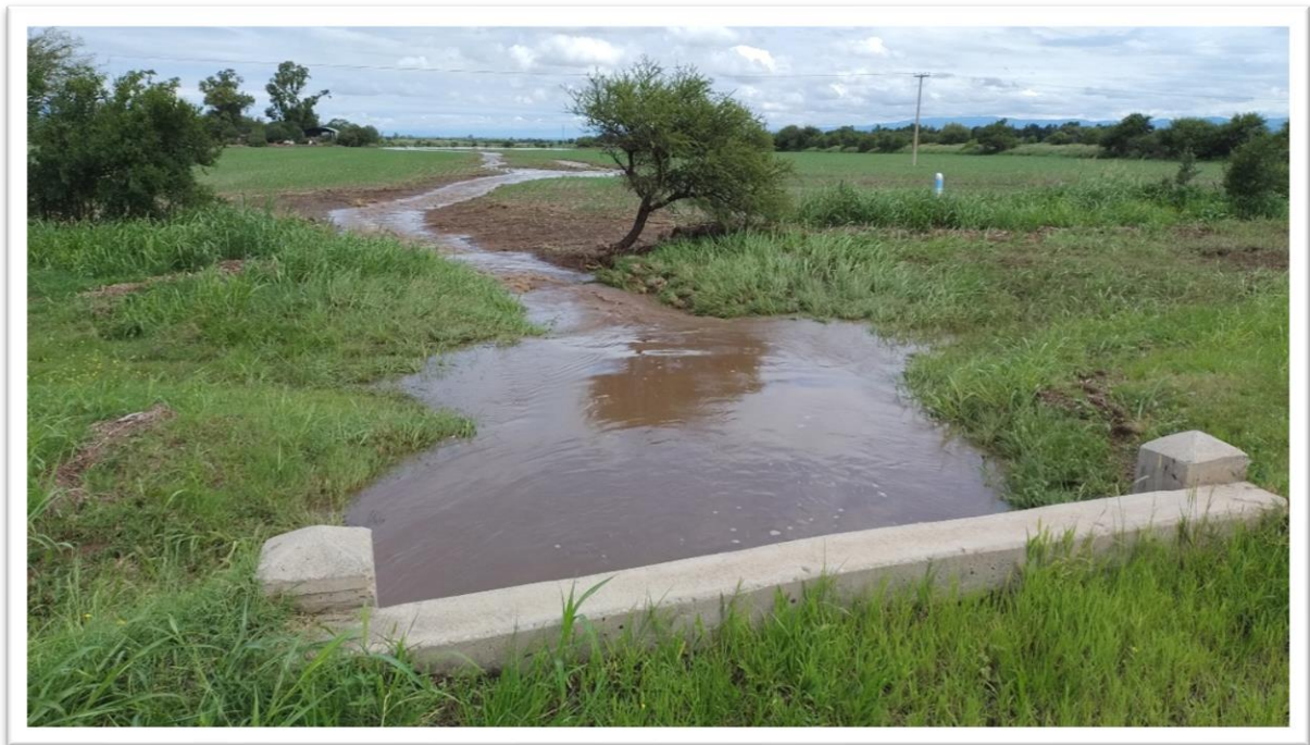
Fotografía 28. Alcantarilla sobre ruta C-45 vista aguas abajo, donde se observan graves daños por erosión en cárcavas.
