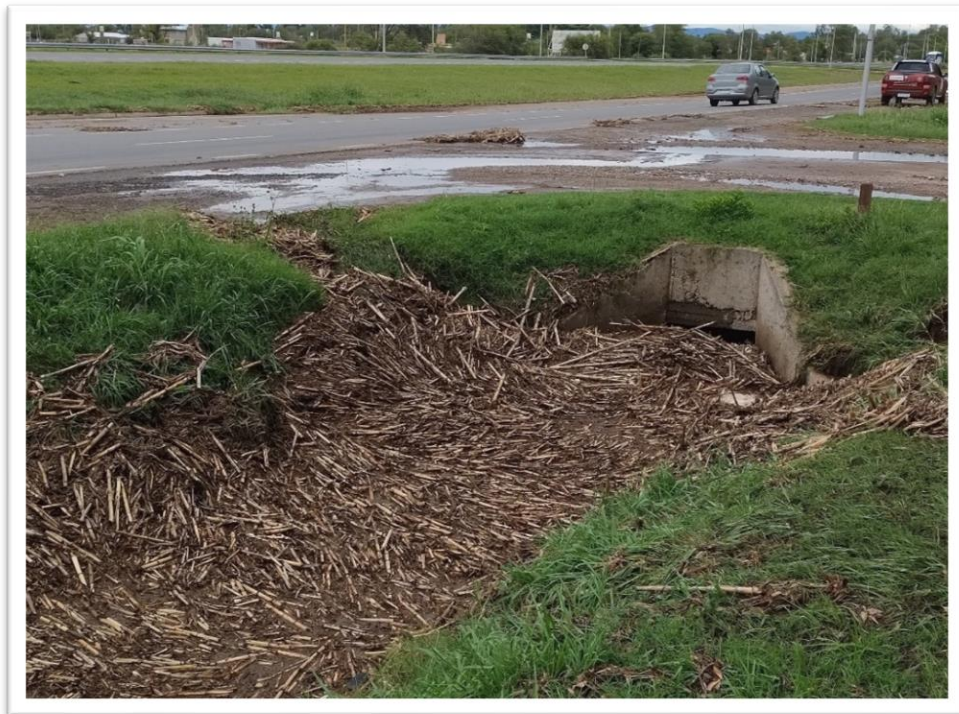
Fotografía 8. Alcantarilla sobre RP N° 5, prácticamente obstruida por rastrojo arrastrado por el agua.
