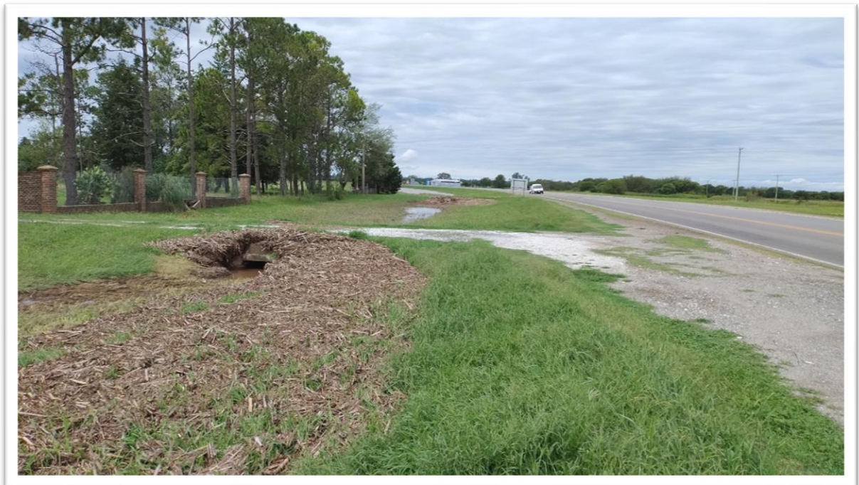
Fotografía 16. Cunetas sobre ruta C-45 con acumulación agua y rastrojo.
