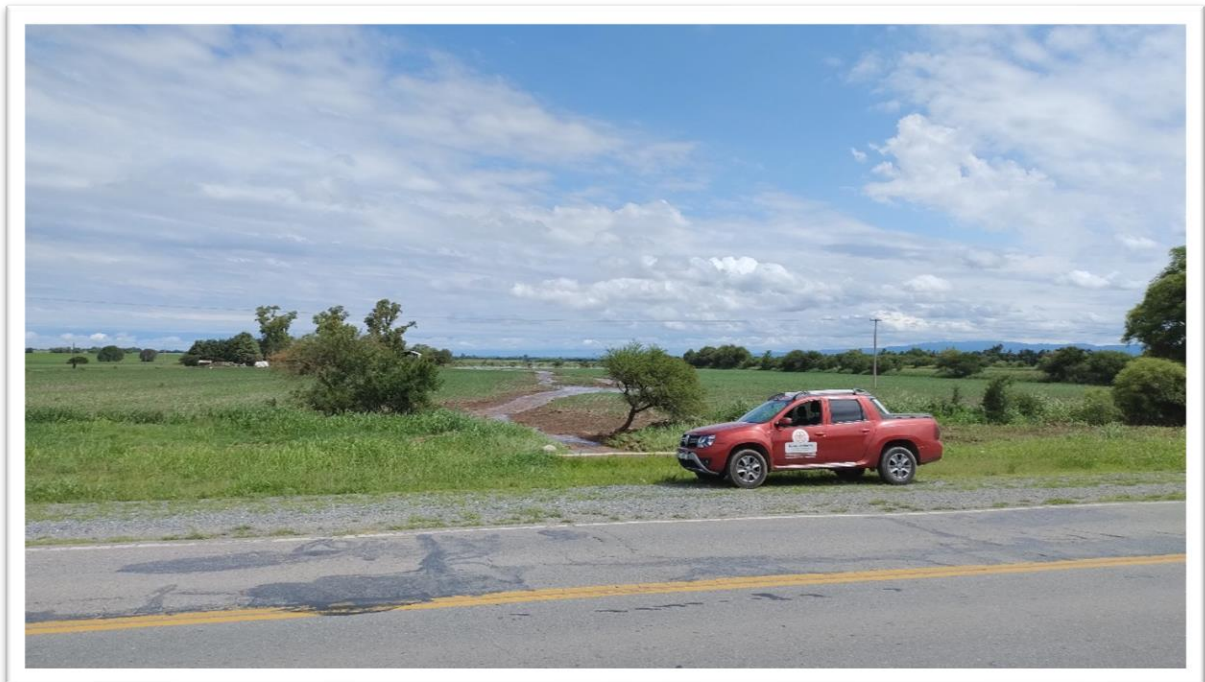
Fotografía 18. Alcantarilla sobre ruta C-45, vista aguas abajo, donde se pueden observar daños por erosión en surcos en el lote.
