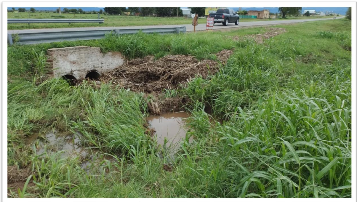
Fotografía 30. Alcantarilla sobre ruta C-45, obstruida por sedimentación, vegetación y rastrojo.
