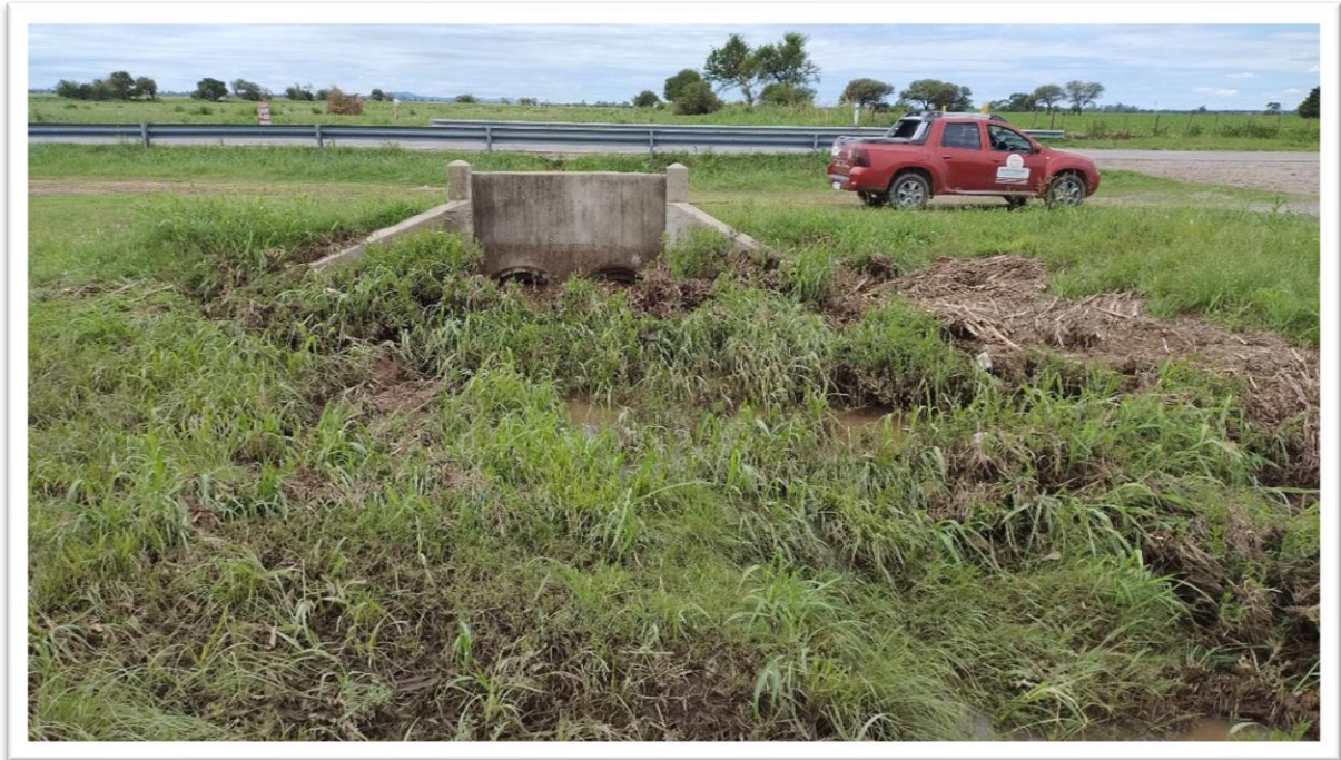
Fotografía 25. Alcantarilla sobre ruta C-45, obstruida por sedimentación y vegetación.
