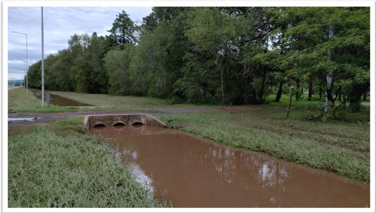
Fotografía 11. Cuneta sobre RP N° 5 llegando a Villa del Prado, a su máxima capacidad con signos de haber sido desbordada.
