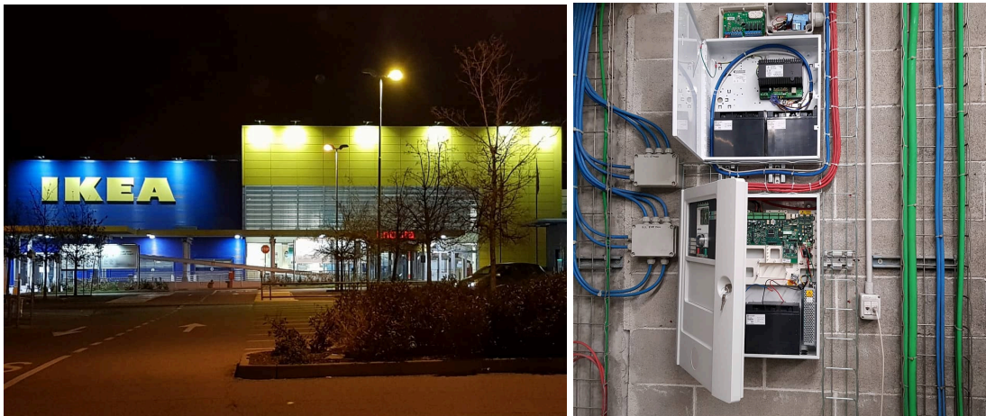
Ilustración 10: Instalación eléctrica tradicional - IKEA - Padova, Veneto, Italia. 2019. Fuente: https://www.facebook.com/siegsrl/ .
