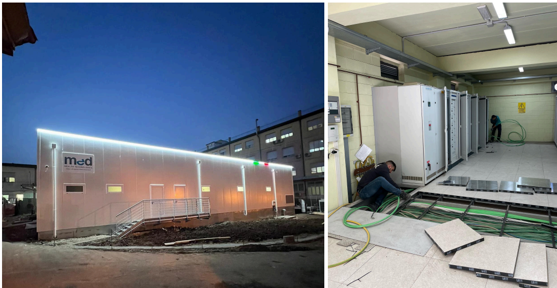
Ilustración 9: Instalación eléctrica tradicional - Obra Modulo de Terapia Intensiva Hospitalale Jazzolino - Vibo Valentia, Calabria, Italia. 2023. Fuente: https://www.facebook.com/siegsrl/ .
