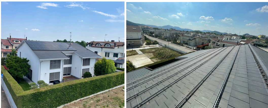
Ilustración 11: Instalación eléctrica fotovoltaica Residencial - Montegrotto Terme, Veneto, Italia. 2022. Fuente: https://www.facebook.com/siegsrl/ .
