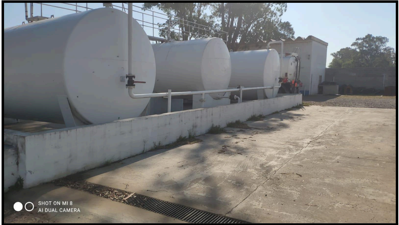
Figura N° 23 – “Tanques delanteros – vista trasera”
