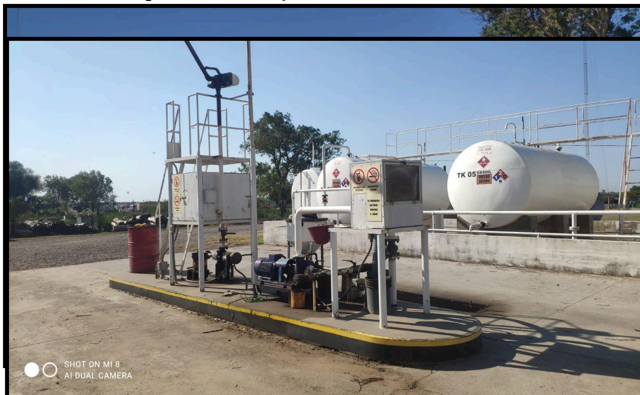
Figura N° 21 – “Tanques traseros – vista frontal”
