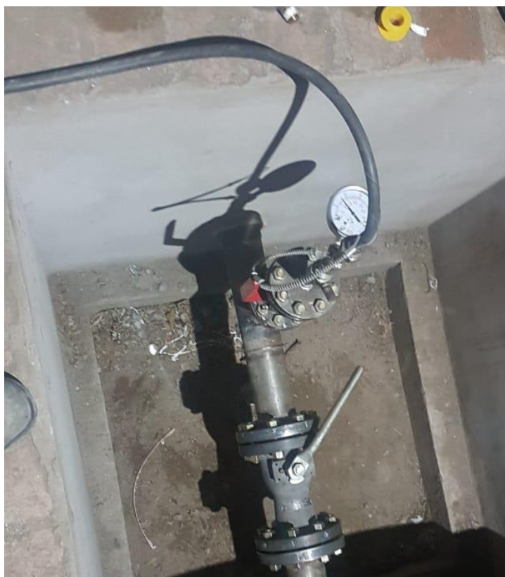
Conexión estándar para la carga de alta presión de un gasoducto.
