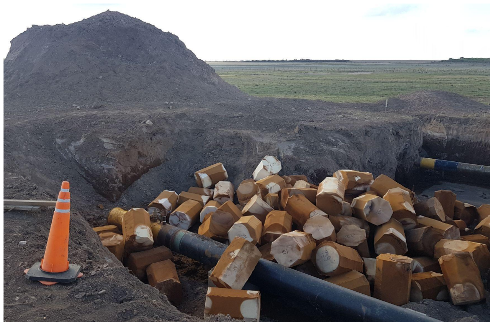
Acumulación de esponjas de poliuretano sucias utilizadas para la limpieza del gasoducto.
