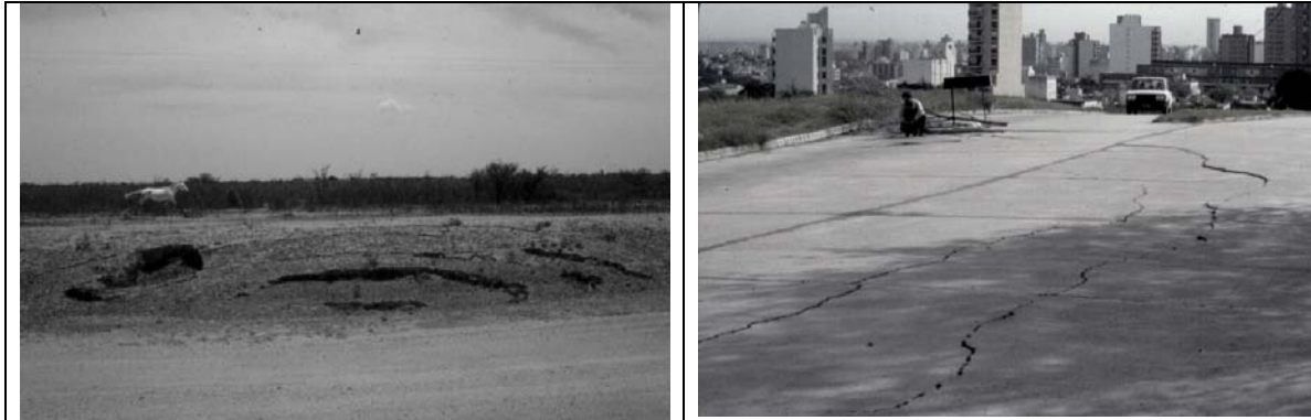
Figura 3: Formación de cráteres. a) zona rural por infiltración de agua de lluvia, b) zona urbana por pérdida de un hidrante.
