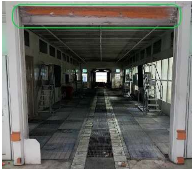
Figura 4.68: “Portón de seguridad de la celda robotizada”
