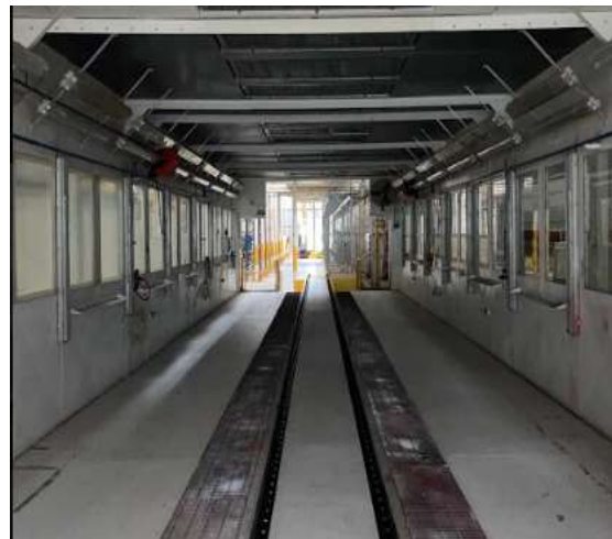
Figura 4.14: “Celda de Retoques”
