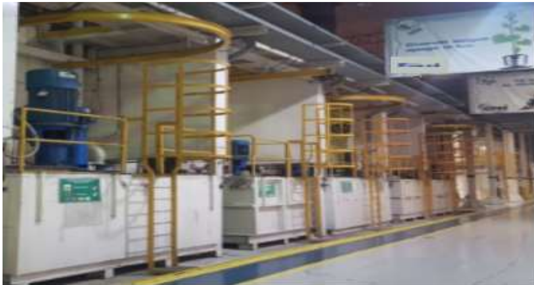
Figura 4.5: “Planta de pretratamiento superficial”
