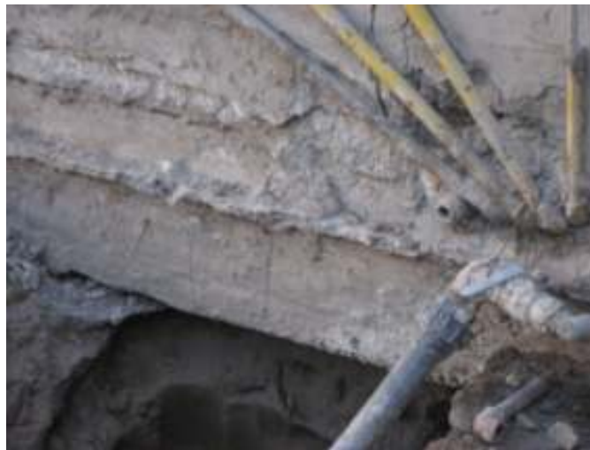
Figura 3. Fisura en la viga de fundación
