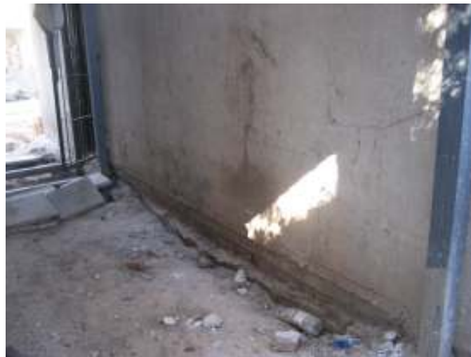
Figura 5. Fisuras en fachada Noroeste
