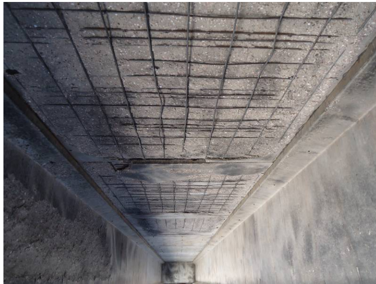
Figura 6. Prelosas afectadas del tablero del Puente N° 2
