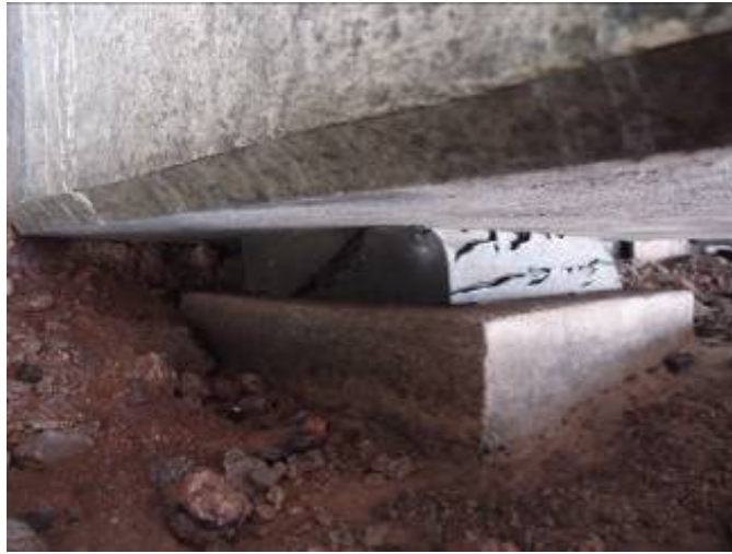
Figura 7. Daños en apoyos de neopreno
