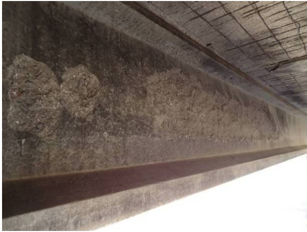
Figura 4. Viga V1 – Cara Sur
