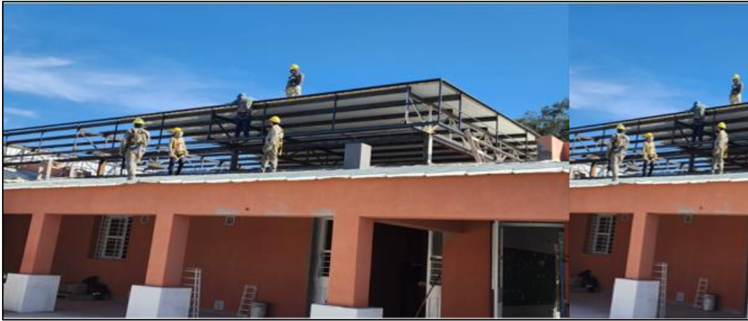
Figura 13 - Forma incorrecta de Izado de paneles para cerramiento de SUM.
