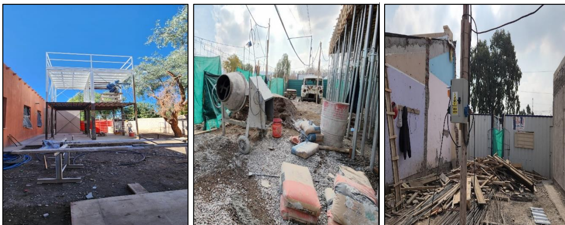
Figura 9 Falta de orden y limpieza. Relevamiento en diferentes puestos de trabajo.
