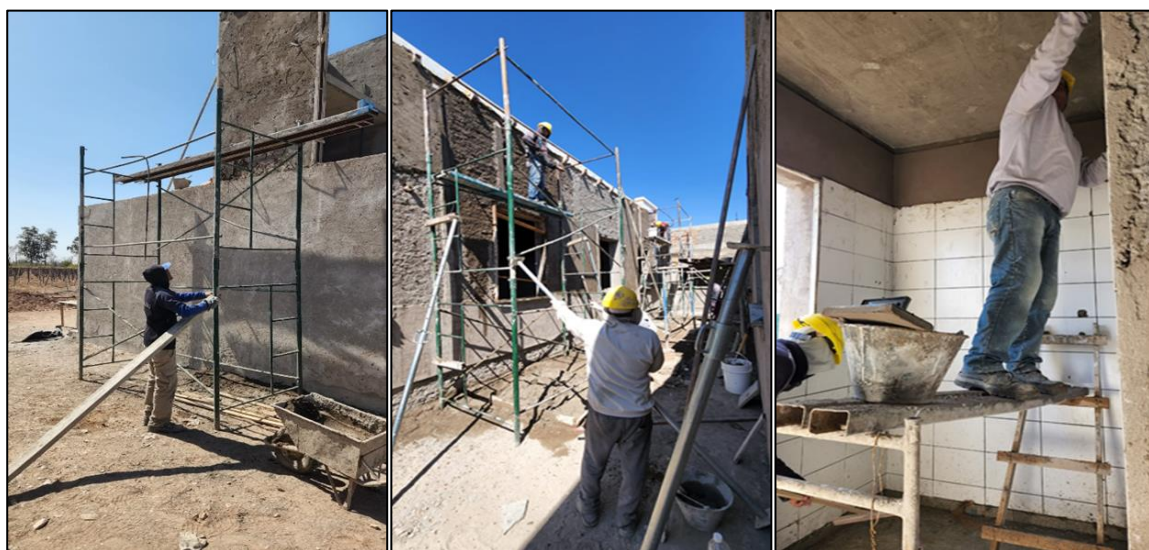
Figura 12 -Forma incorrecta de armado de andamio. -Inexistencia de baranda en el 2do cuerpo del andamio. Falta de Epp. -Plataforma inestable, no cumpliendo con la norma vigente.
