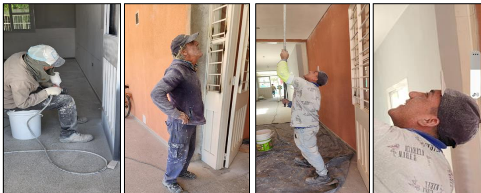
Figura 15 -Uso inadecuado y o inexistencia completa de EPP.
