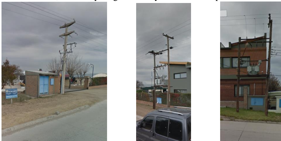
Acometidas eléctricas sobre vereda
