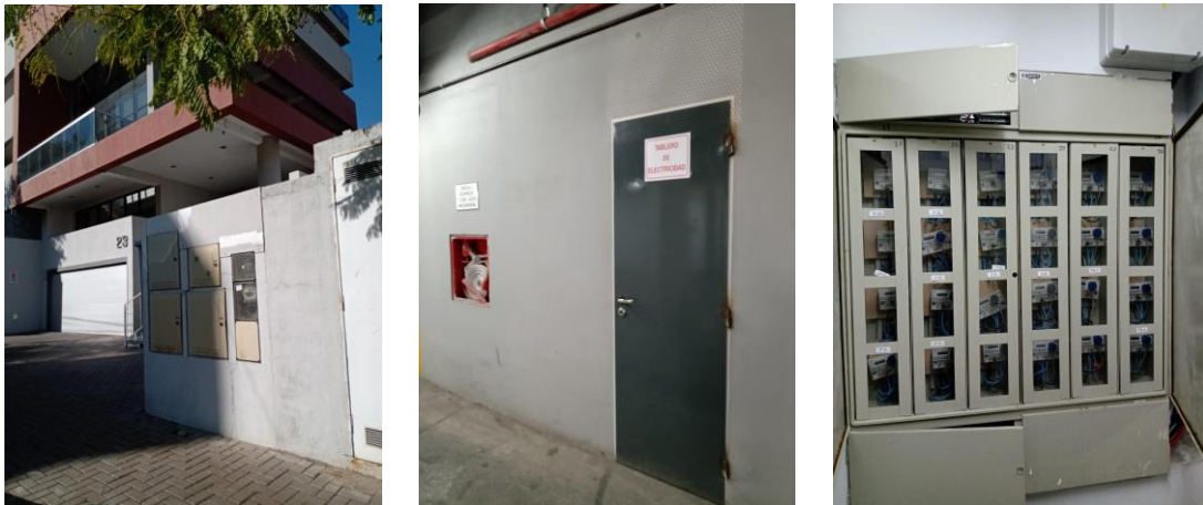
Figuras 1.5 - 1.5.1 – 1.5.2 Instalación eléctrica
