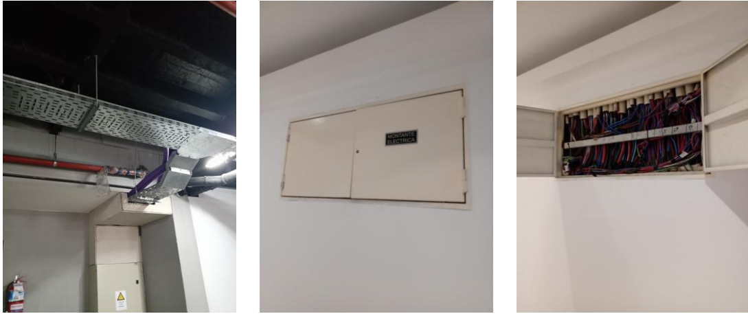
Figuras 1.5.3 - 1.5.4 – 1.5.5 Instalación eléctrica
