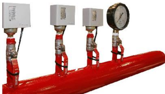
Detalle de presostatos en el colector de impulsión
