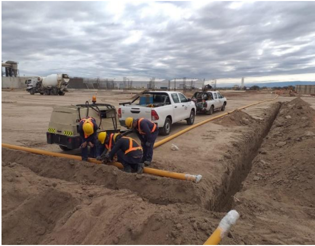
Ilustración 23 - Unión de cañerías
