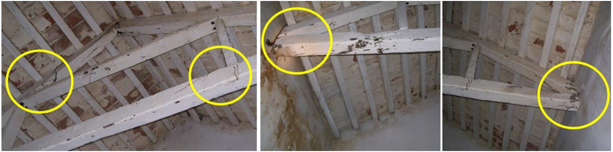
Figura 9. Cabriada. Manifestaciones patológicas relevadas en pares y tirante, y en apoyos
