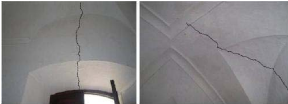
Figura 12. Sector de habitación D9 con fisuras
