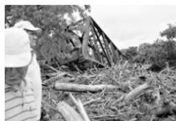
Ayer comenzaron los trabajos para remover el puente ferroviario, arrastrado por la creciente.
