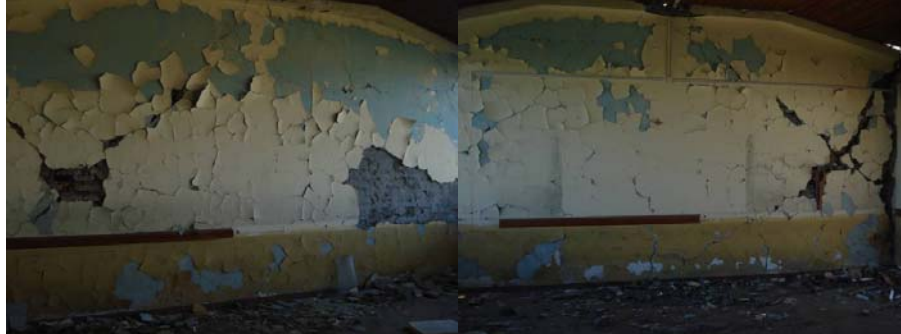
Fotografía 15. Daños en muros del último nivel.
