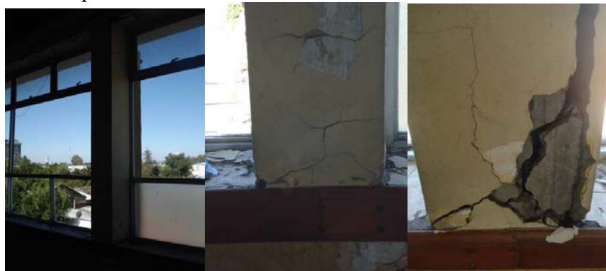
Fotografía 17. Falla en columnas.
