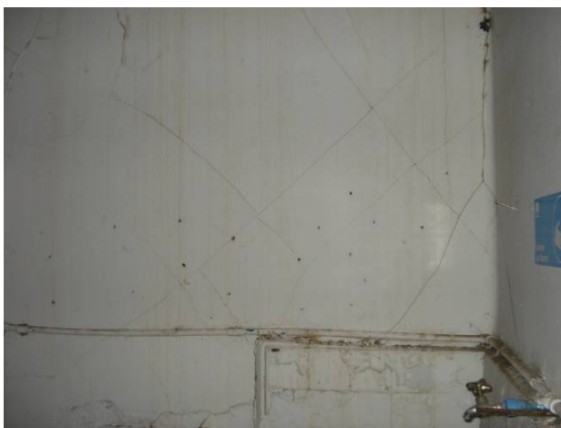
Fotografía 4. Fisuras en forma de cruz debidas a esfuerzos cortantes en el plano del muro.
