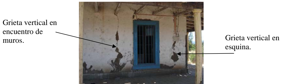
Fotografía 1: Grieta vertical en encuentro de muros y grieta vertical en esquina.
