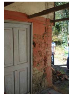
Fotografía 3. Grieta vertical en esquina de muro.
