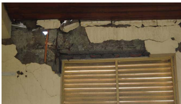
Fotografía 16. Falla en viga-columna.
