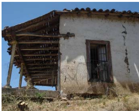
Fotografía 2. Grieta vertical en encuentro de muros.
