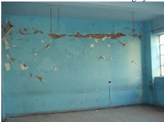
Fotografía 11 Daños múltiples producidos por esfuerzos cortantes en el plano y falla en unión entre viga y muro.
