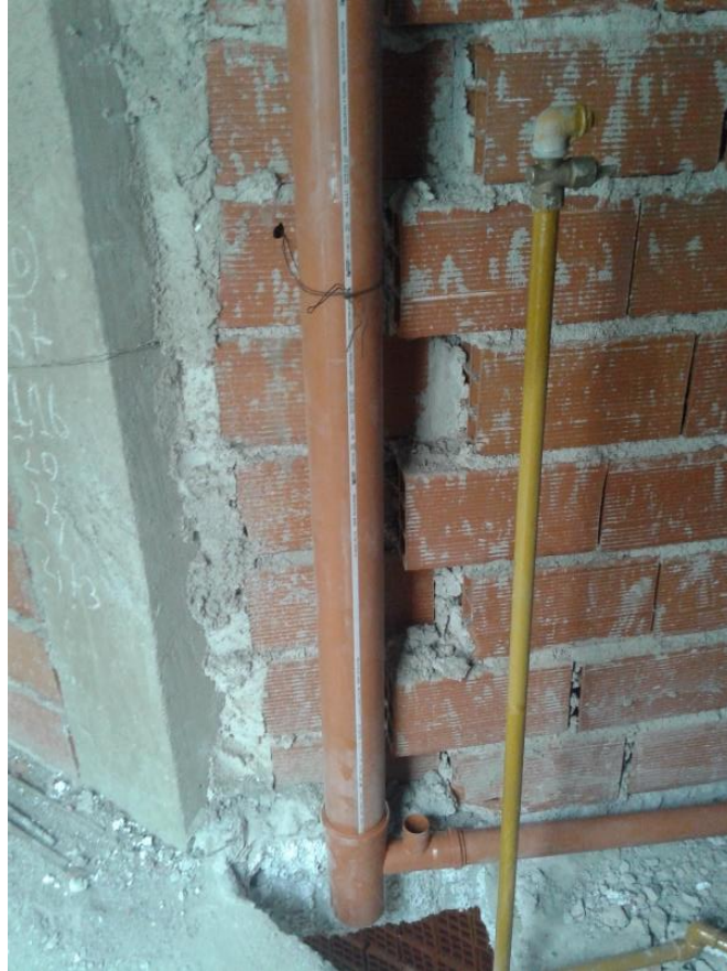
Figura 3.28: Espacio técnico para la montante.
