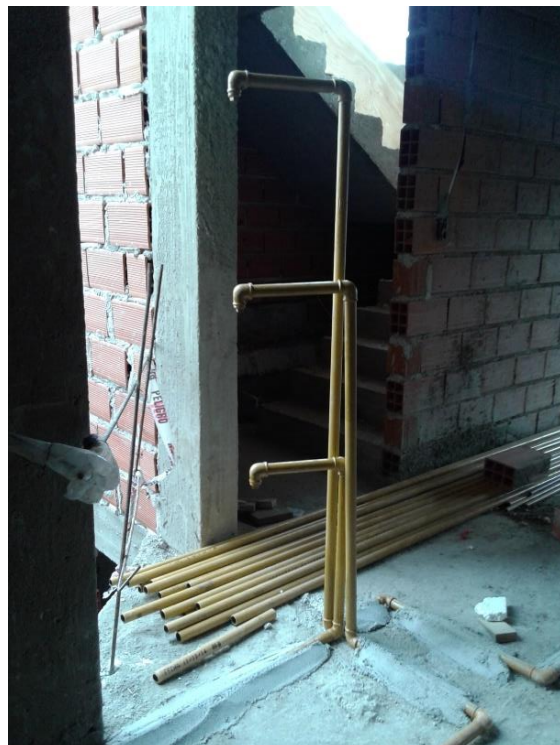
Figura 3.27: Instalaciones de gas.
