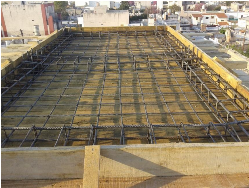
Figura 3.15: Encofrado y armado de losa de tanque de agua, previo a hormigonar.
