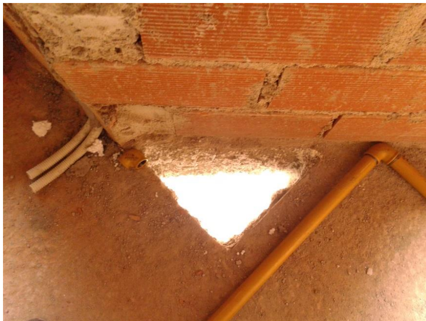
Figura 3.29: Espacio técnico para la montante.
