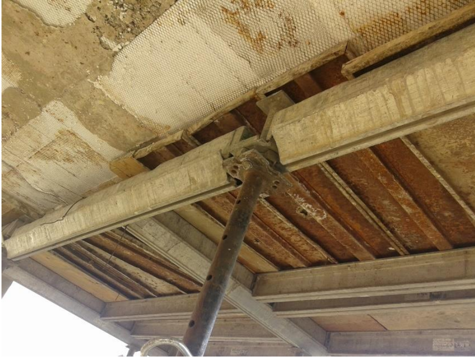
Figura 3.5: Vista inferior del encofrado de losa. Se destaca un puntal metálico, tablero metálico de fondo, las banquinas o vigas primarias y las soleras o vigas secundarias.
