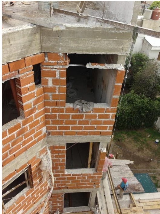
Figura 4.24: Incorrecta ejecución de vanos.
