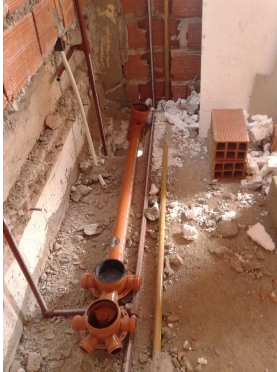
Figura 3.22: Instalaciones de agua, cloacal, de gas en la cocina del Departamento 1°A.
