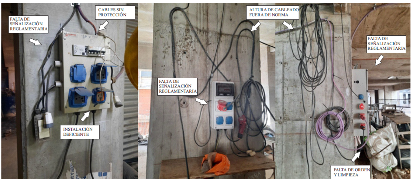
1.27 Situación de Instalación eléctrica en Obra
