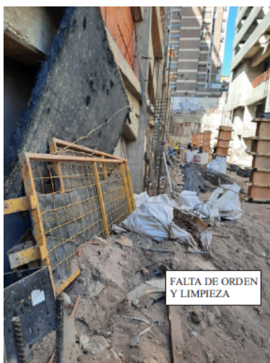
1.20 Falta de Orden y Limpieza en Obra
