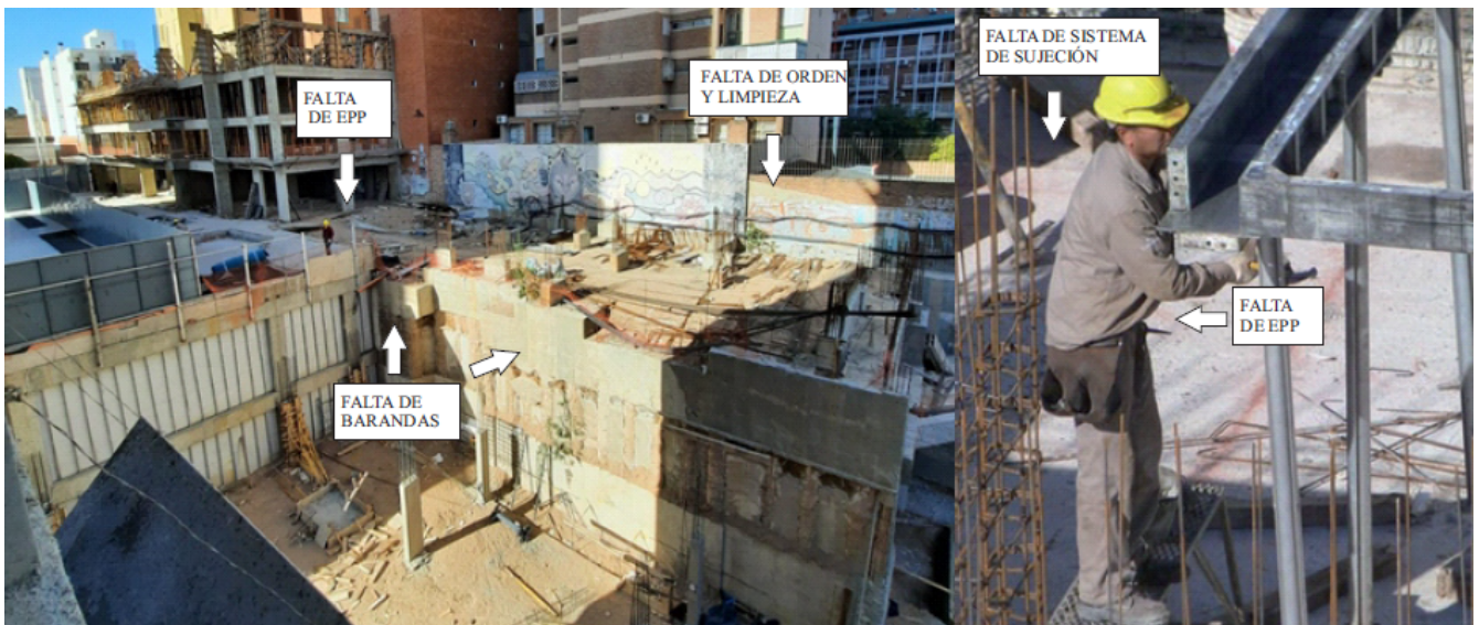
1.25 Trabajadores desarrollando tareas que implican riesgo de caída a distinto nivel
