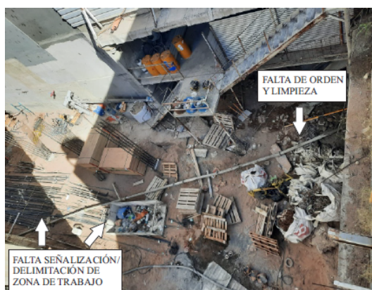
1.21 Falta de Orden y Limpieza en Obra
