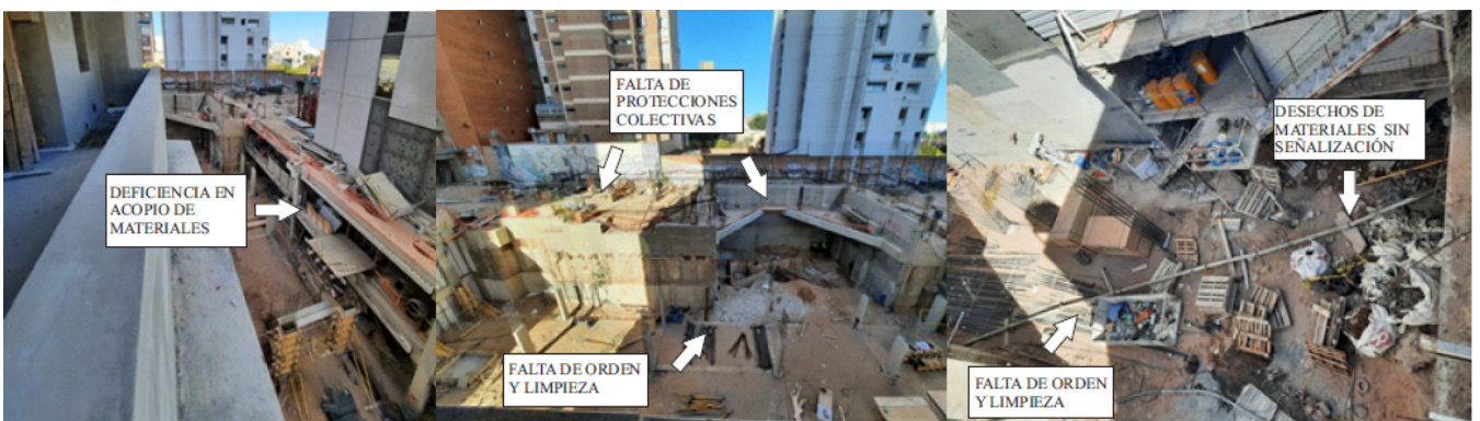
1.26 Áreas de Trabajo: Se observa la falta de organización en espacios de acopio, no existe delimitación de bordes
