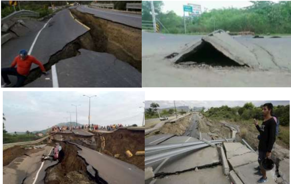
Figura 58. Destrucción de las principales vías terrestres debido al terremoto. Foto: Reuters Media Express.
