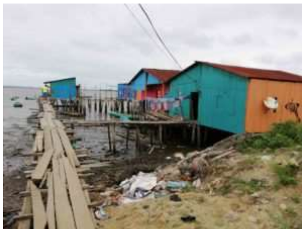
Figura 44. Acceso a viviendas en mal estado post terremoto en San José de Chamanga. (Foto cortesía).
