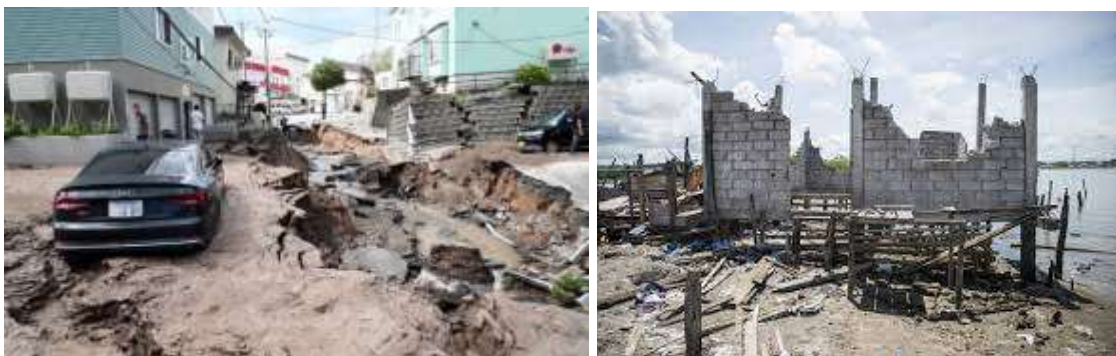
Figura 56. Vías e infraestructuras destruidas por el terremoto en Muisne. (Foto cortesía)
