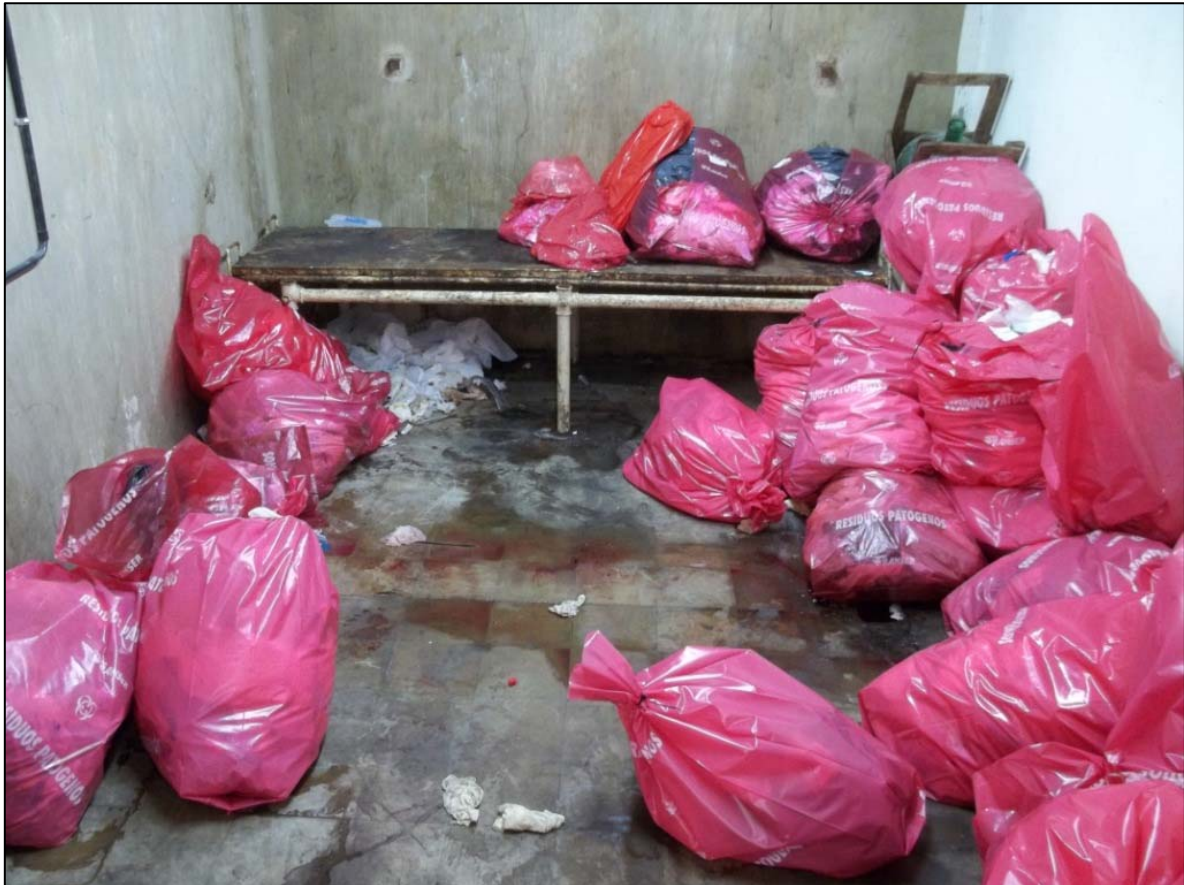
Figura 5.4: Fotografía del SDT antes de intervención
