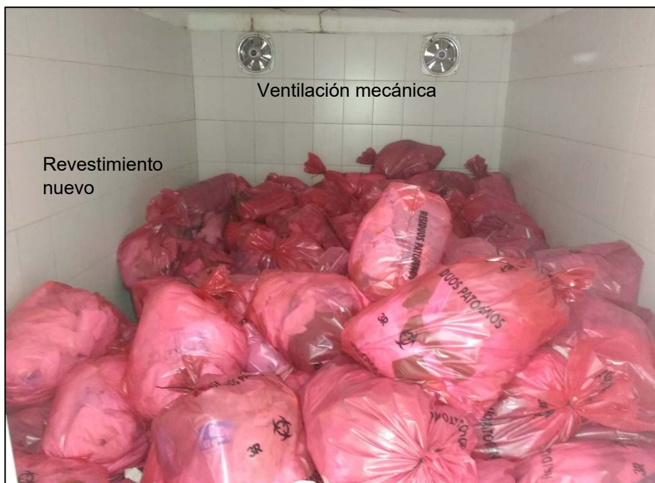
Figura 5.6: Vista del interior del SDT mejorado con el revestimiento cerámico y la ventilación
