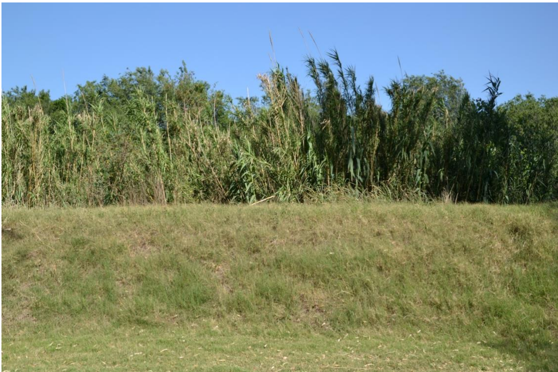
1. Muro de defensa en el río Chocancharava en la localidad de La Carlota. Imagen del 2021.
