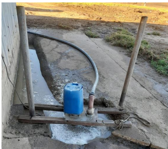
Figura N°1 anexo: Bomba impulsando los efluentes del lavado.
