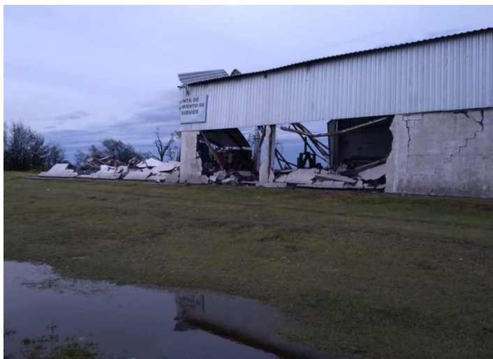
Fig. 12. Planta de separación de RSU después del tornado (Municipalidad de Laborde, 2021)
