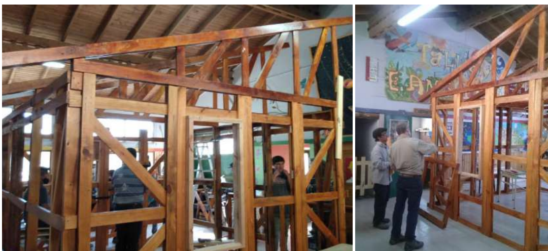
Figura Nº70: Montaje del primer módulo habitacional en el taller de la Escuela Integral Angelelli. (Fuente: Archivo fotográfico del Programa de Investigación “Co-construcción del Conocimiento”. Dir: Paula Peyloubet).
