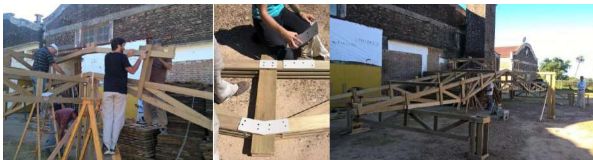
Figura N°41: Montaje experimental de estructura de techo para Galpón de Tratamiento de residuos. (Fuente: Archivo fotográfico del Programa de Investigación “Co-construcción del Conocimiento”).
