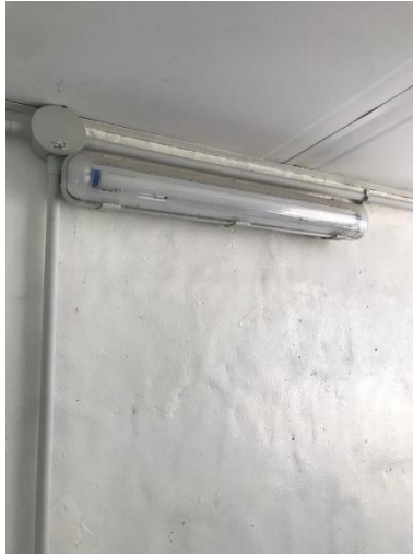
Figura 20: Vista de luminaria protegida.
