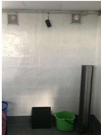
Figura 23: Vista de la prensa, rejillas de ventilación y protecciones eléctricas.
