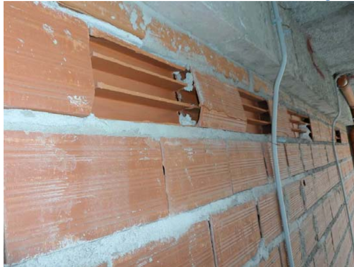
Fig. 7 – Explosión de bloques cerámicos en cerramiento lateral sobre medianera
