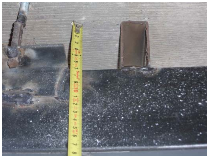
Fig. 3 – Medición en extremo de viga de la flecha (7 cm)
