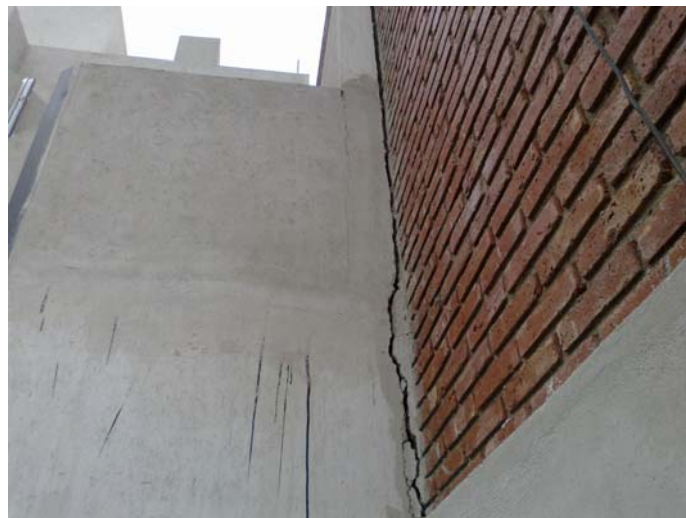
Fig. 8 – Daños debido a golpeteo con edificio vecino
