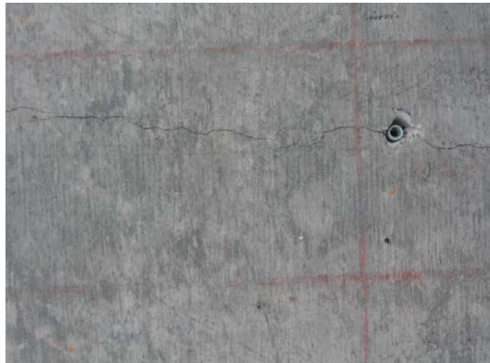
Fig. 5 – Fisura en fondo de viga transversal extrema
