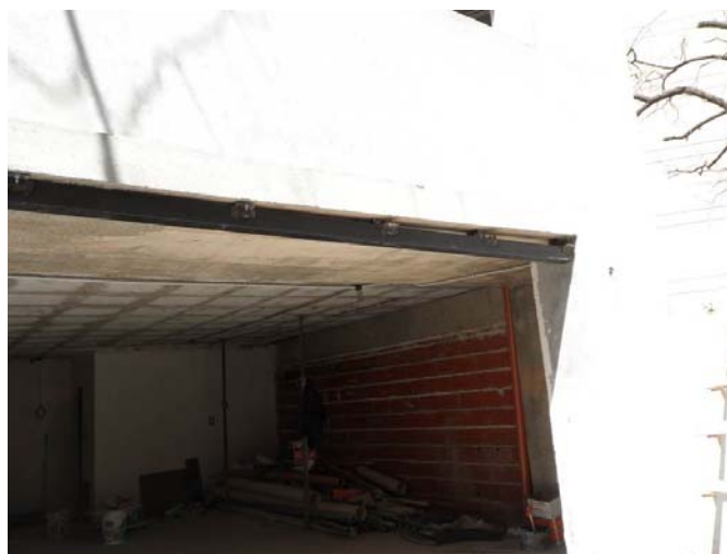
Fig. 4 – Deformada de viga transversal extrema en primer piso
