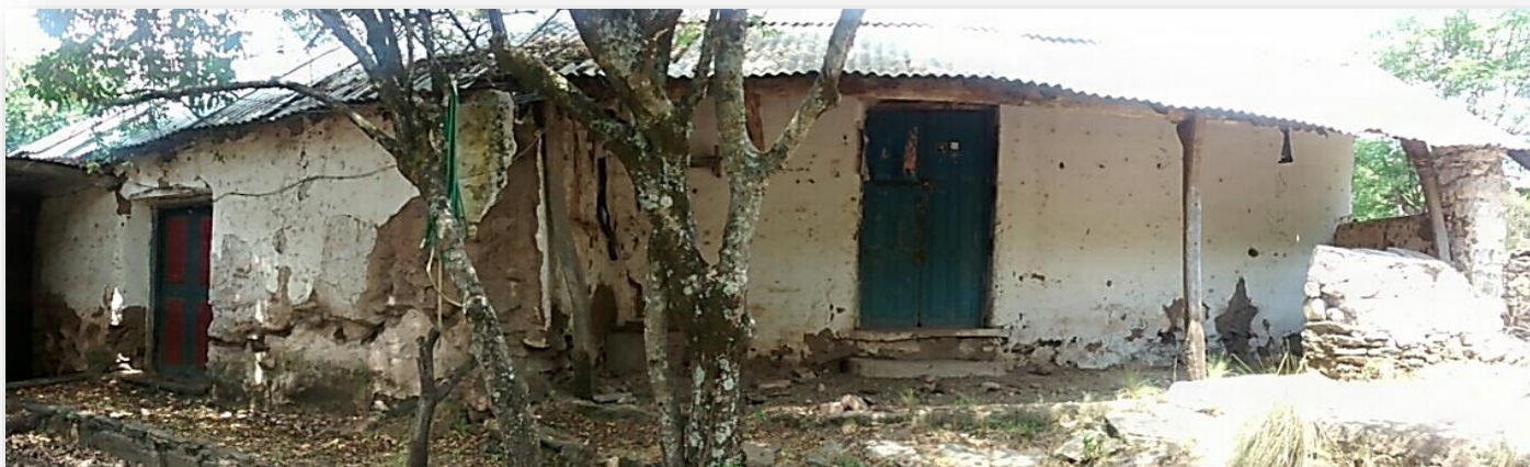
Imagen 5.17 : vista desde el oeste a la galería techada y puerta de acceso al conjunto de Las Tranquitas
