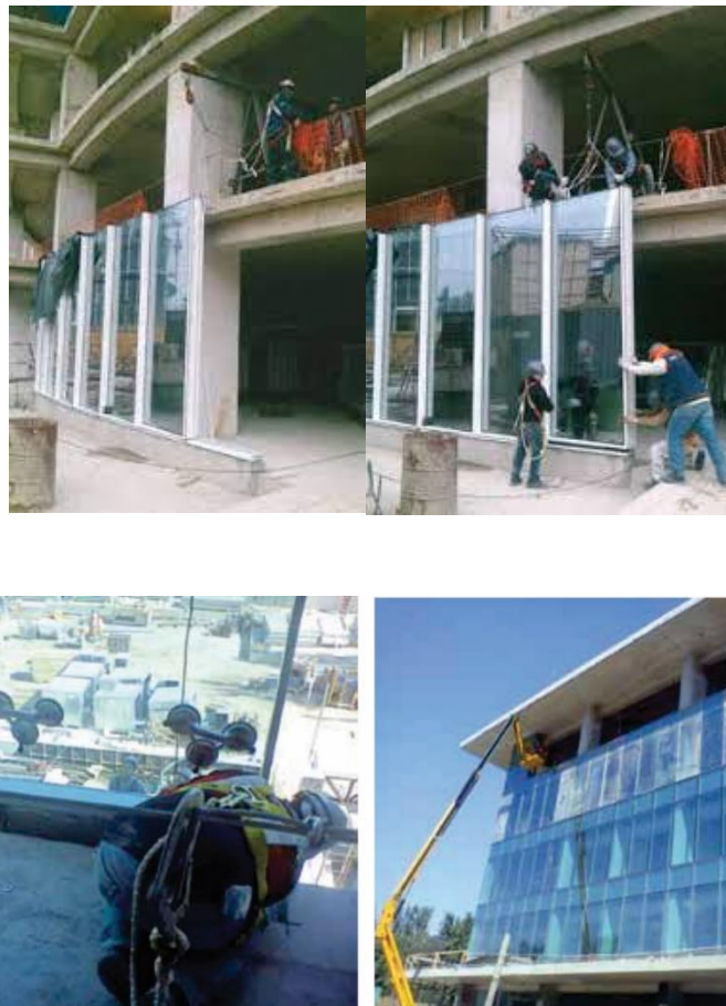
Imagen 5.4 – Curtain Wall: Riesgo Caída de objetos desprendidos en las plantas.
