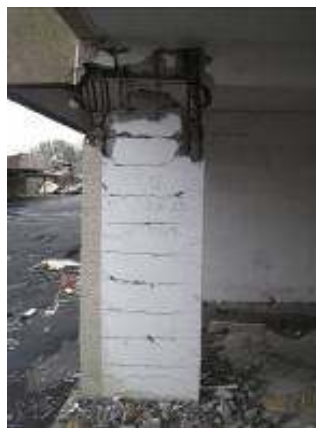
b: Rotura muro Eje U entre Ejes 24 y 25.
