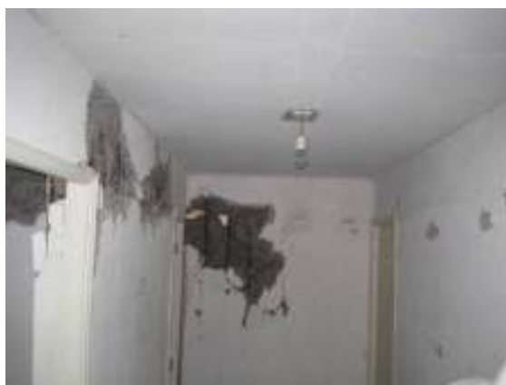
Figura 7: Daño en muro Eje T.
