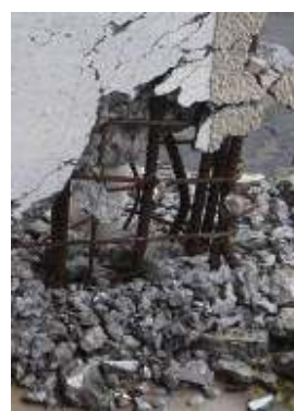
b: Pandeo de barras verticales en extremo de muro.
