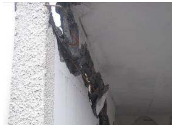
b: Desaplome en muro (vista interior)
