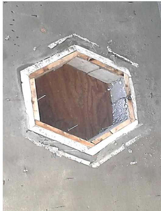
Fig. 3.24. Tapas laterales de inspección del tanque de reserva de agua para incendio.
