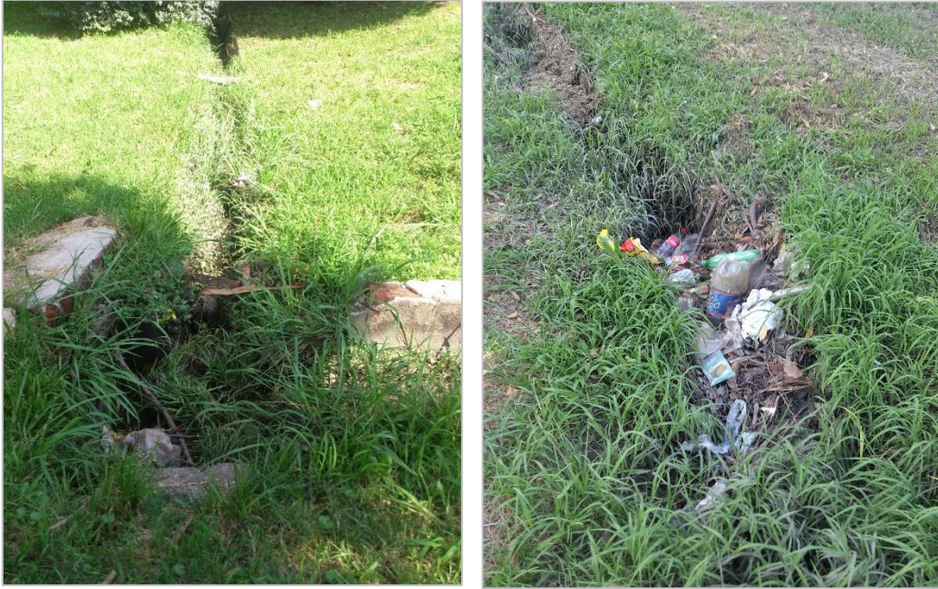
Figura 54: Canal de Desagüe Deteriorado y Anegado
