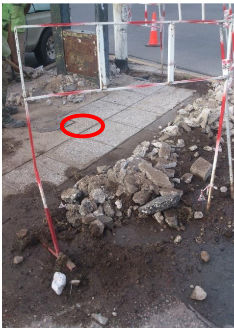
Figura 44: Punto de Referencia luego de Destruído
