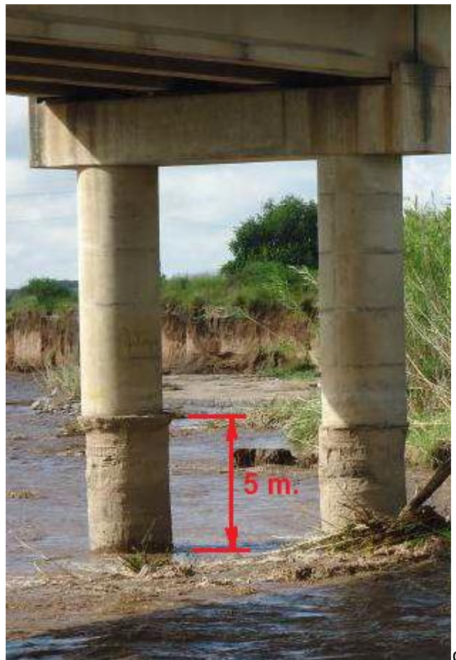
Figura 6.5. Erosión relevada durante la inspección de rutina del puente
