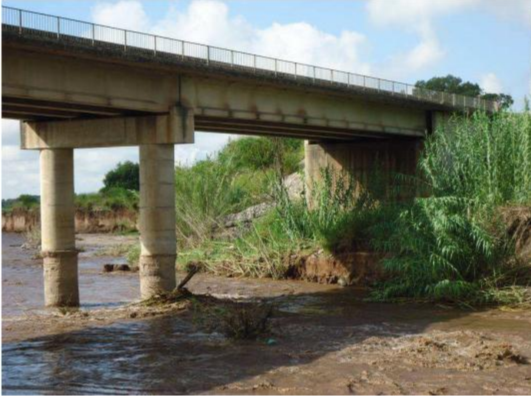
Figura 1.3. Erosión del cauce del río en la pila y estribo sur del Puente Carretero
