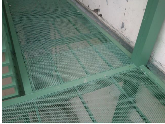
Figura 4.2.12-Metal desplegado en descansos y pasos horizontales
