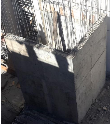
Figura 4.3.79-Estado del tabique del ascensor
