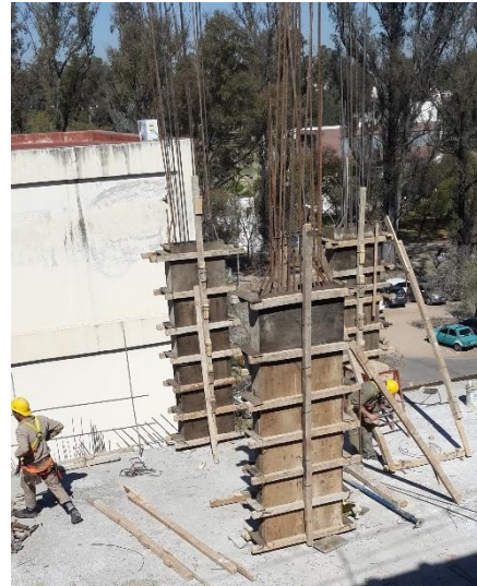
Figura 4.3.78-Estado de las columnas del Nivel 2
