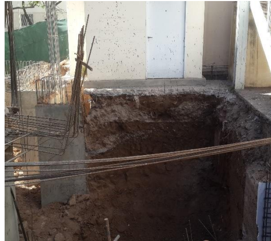
Figura 4.3.80-Estado del muro de contención II
