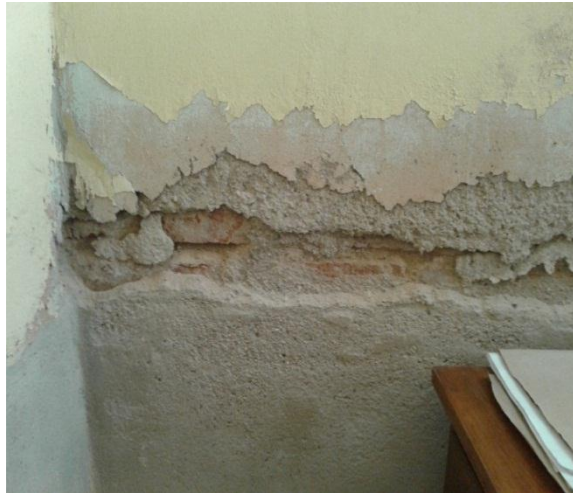
Figura 14.- Desprendimiento de revoque en muro
