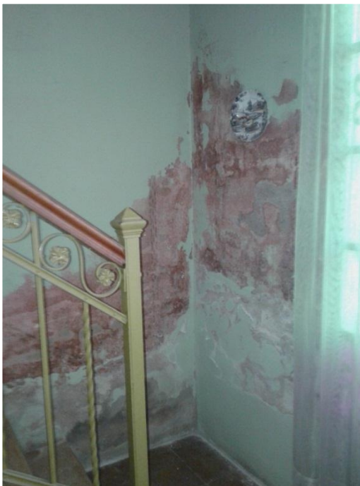
Figura 15.- Presencia de humedad en muro y desprendimiento de revoque.
