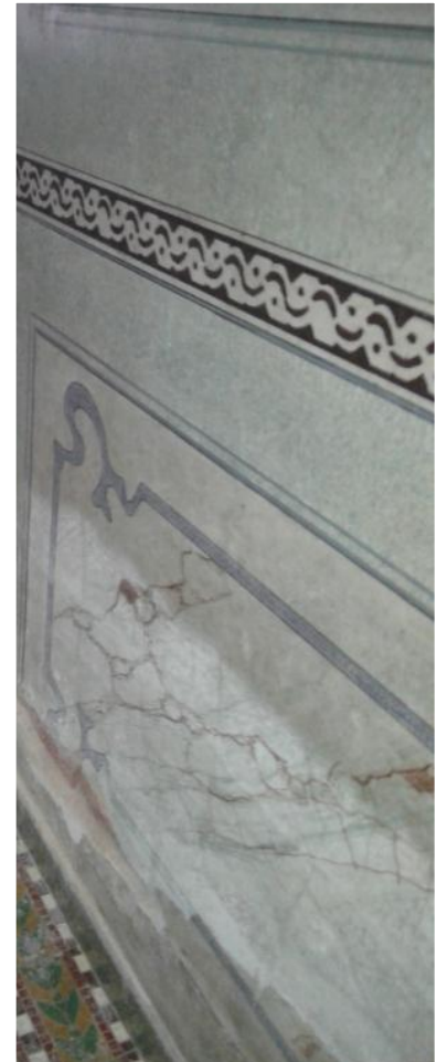
Figura 12.- Eflorescencias sobre el estucado.
