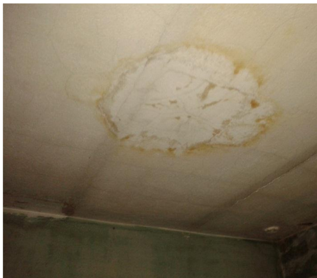
Figura 16.- Presencia de humedad en techo.
