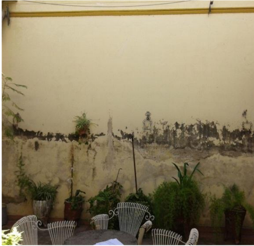
Figura 13.- Presencia de humedad en muro.
