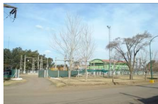
Estación Transformadora de EPEC, Año 2011.
