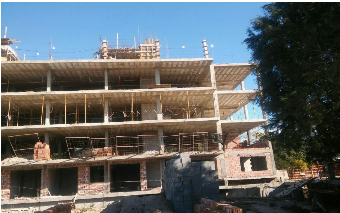
Fig. 2: Estado parcial de Torre IV del Condominio Fontanas del Sur.
